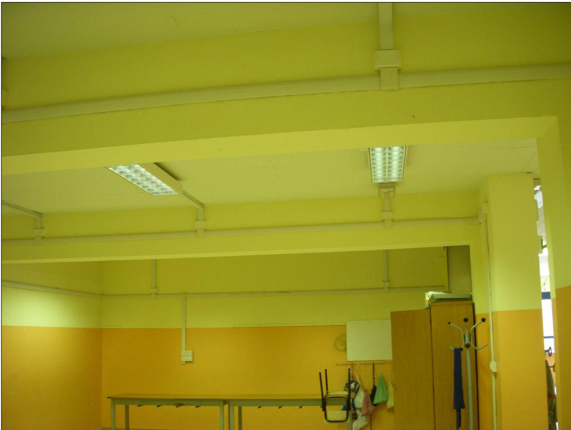
Figura 12 - Vista delle travi ribassate
