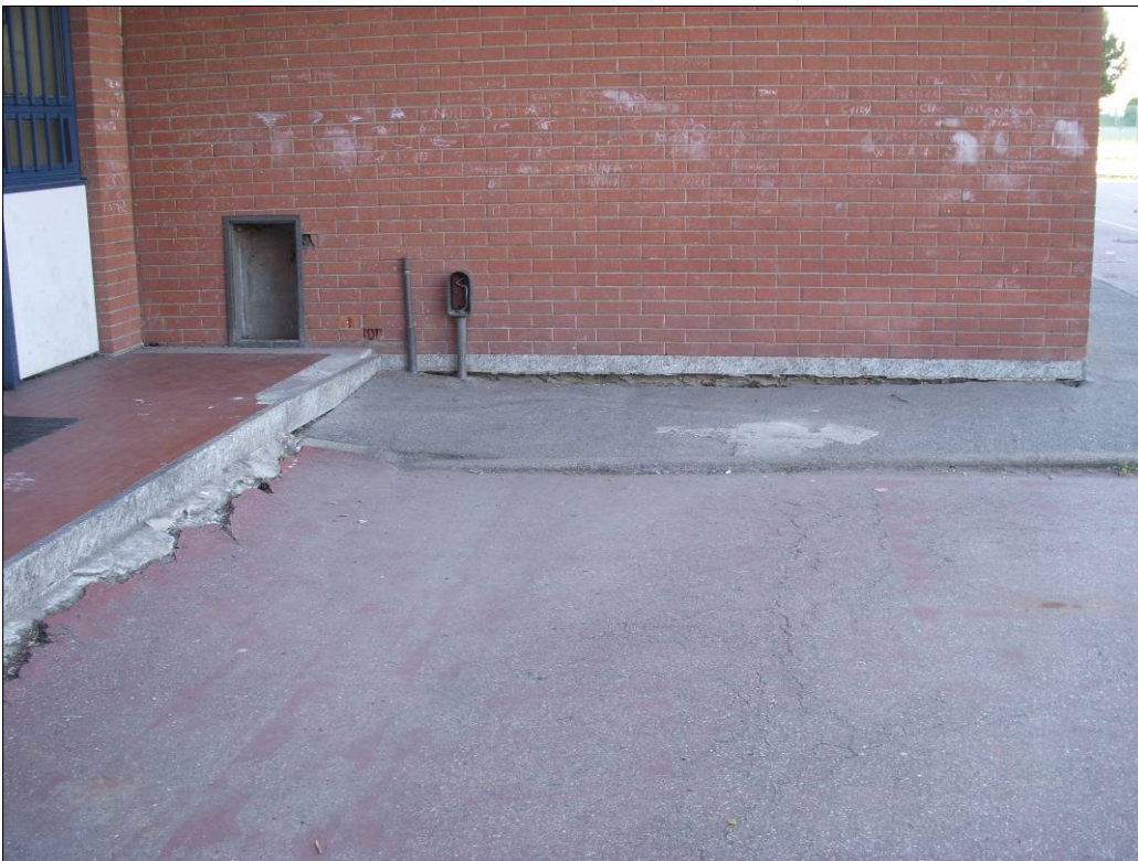
Figura 16 - Cedimento del terreno in corrispondenza del piazzale lato cortile
