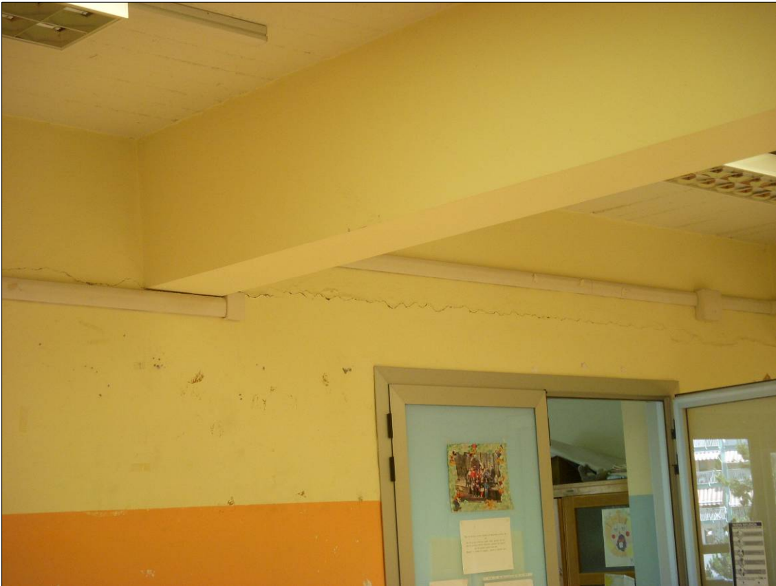
Figura 15 - Fessurazione orizzontale nei tramezzi sotto le travi ribassate
