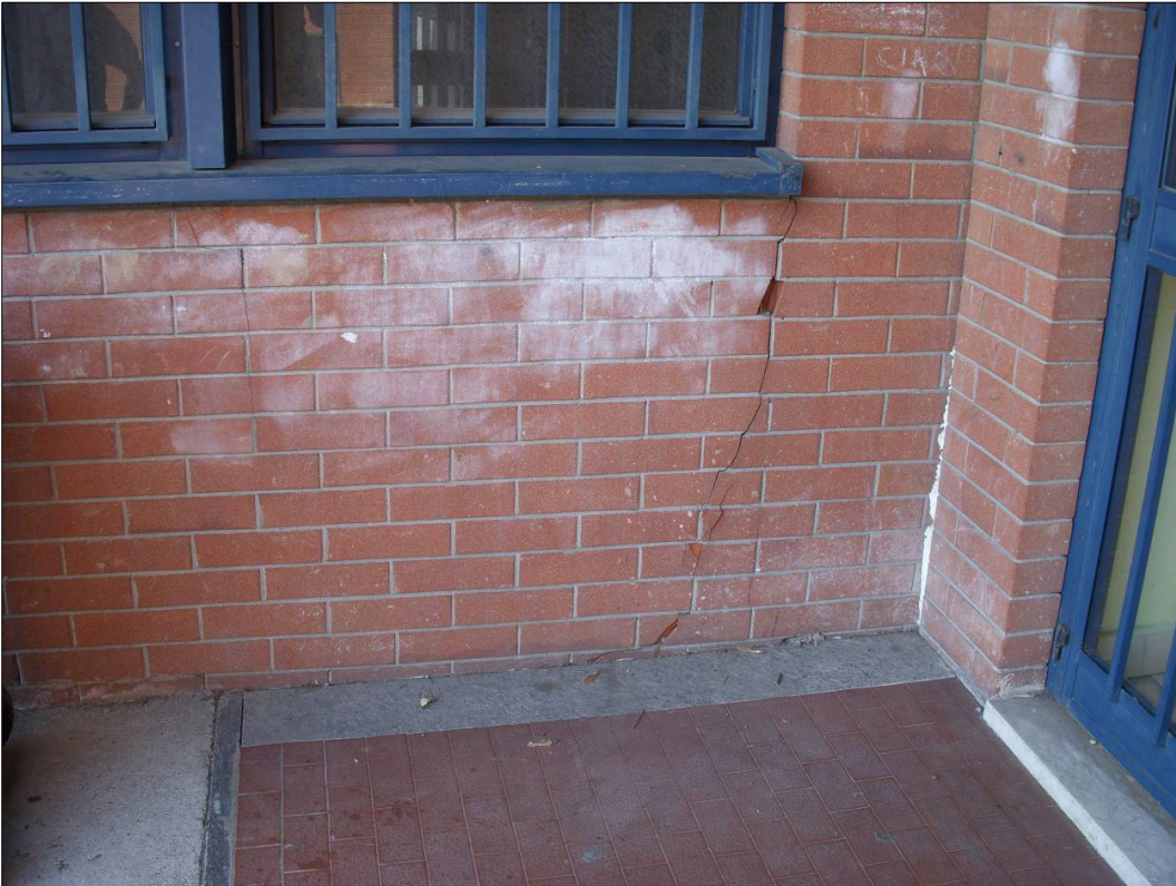
Figura 9 - Fessurazione nella muratura del corpo C2
