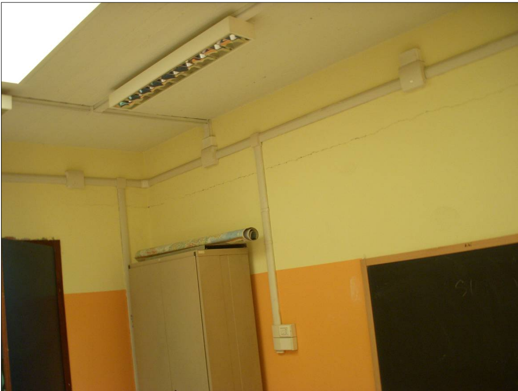
Figura 14 - Fessurazione orizzontale nei tramezzi
