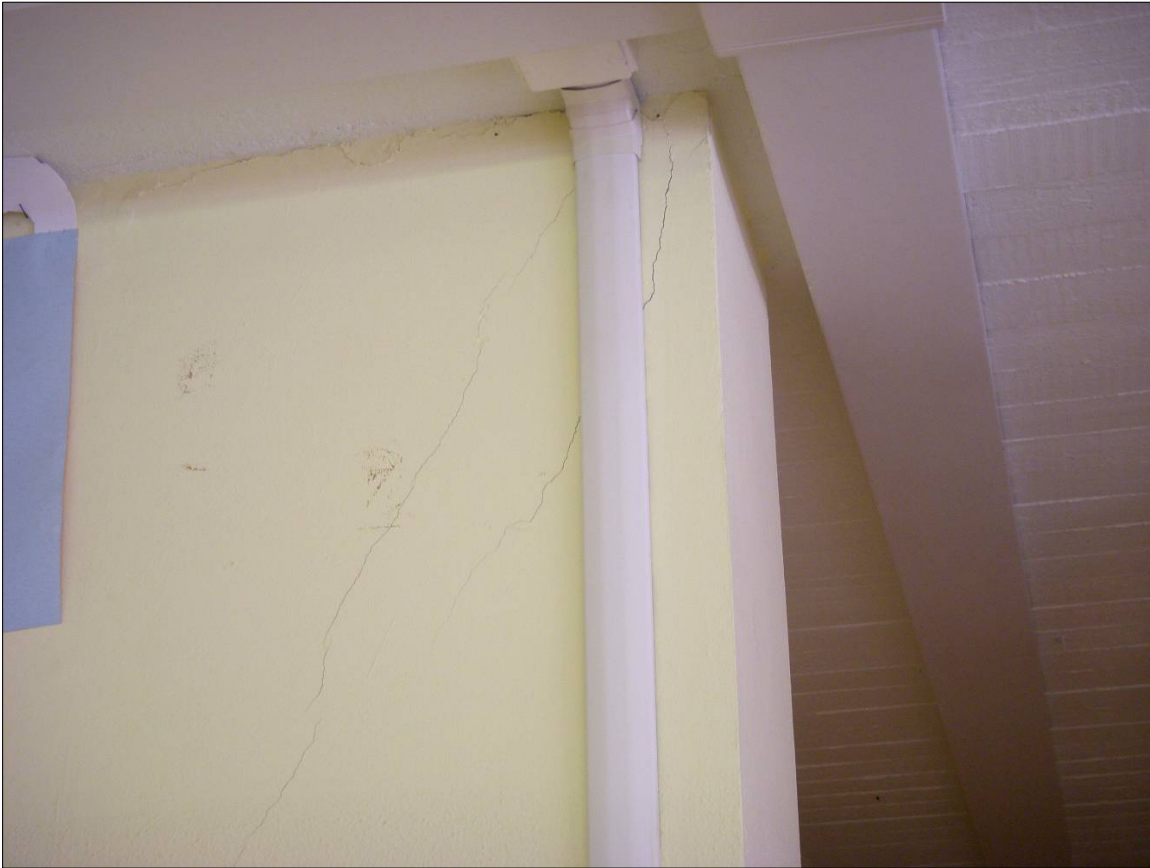
Figura 11 - Fessurazione nel corpo C2 al primo piano (2° f.t.)
