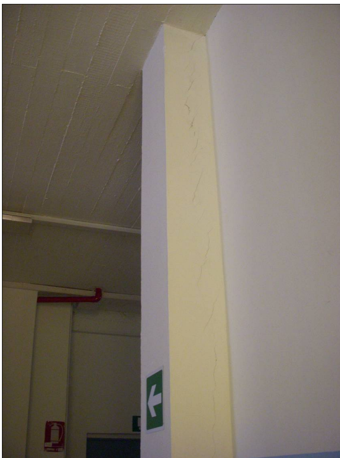
Figura 10 - Fessurazione nel pilastro P26 del corpo C2
