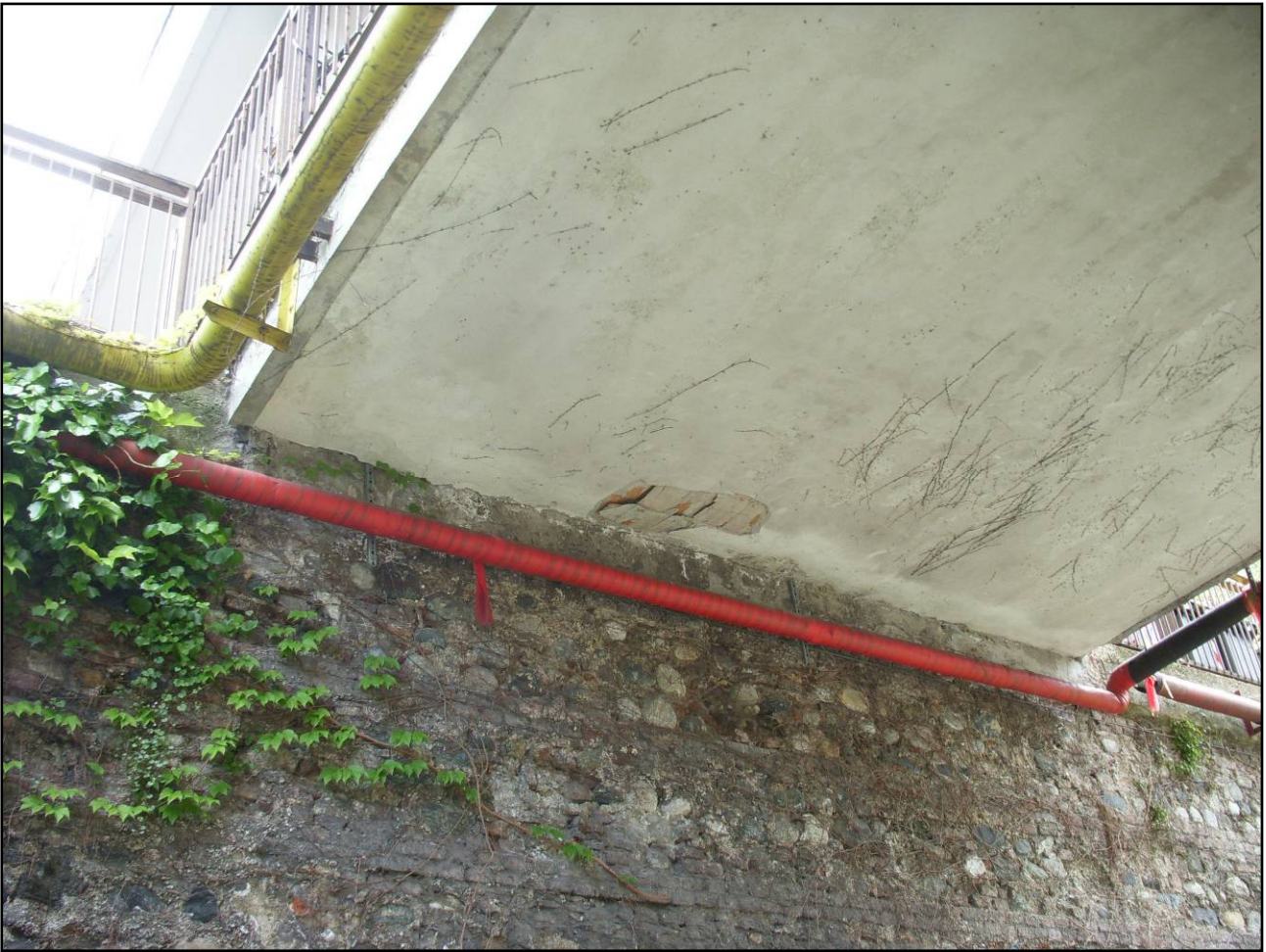
Figura 15 - Sfondellamento dei blocchi del solaio del porticato di accesso
