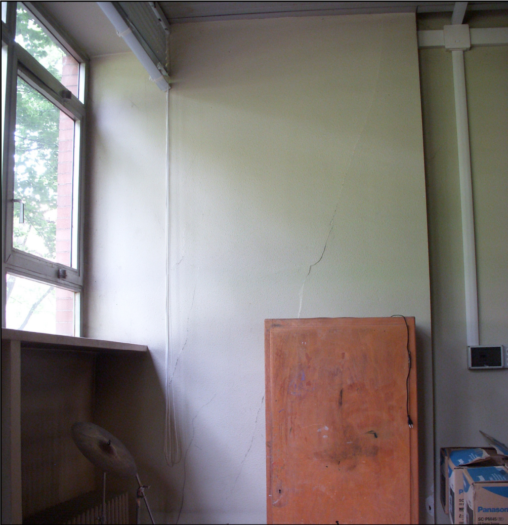
Figura 13 - Fessura diagonale del tramezzo corpo 2 a livello interrato (laboratorio musicale)
