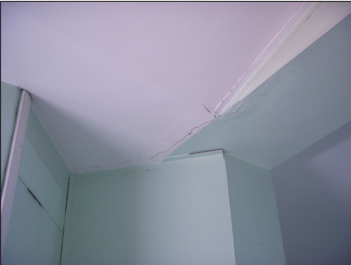
Figura 10 - Fessurazione vano scala corpo 1 (creazione giunto)
