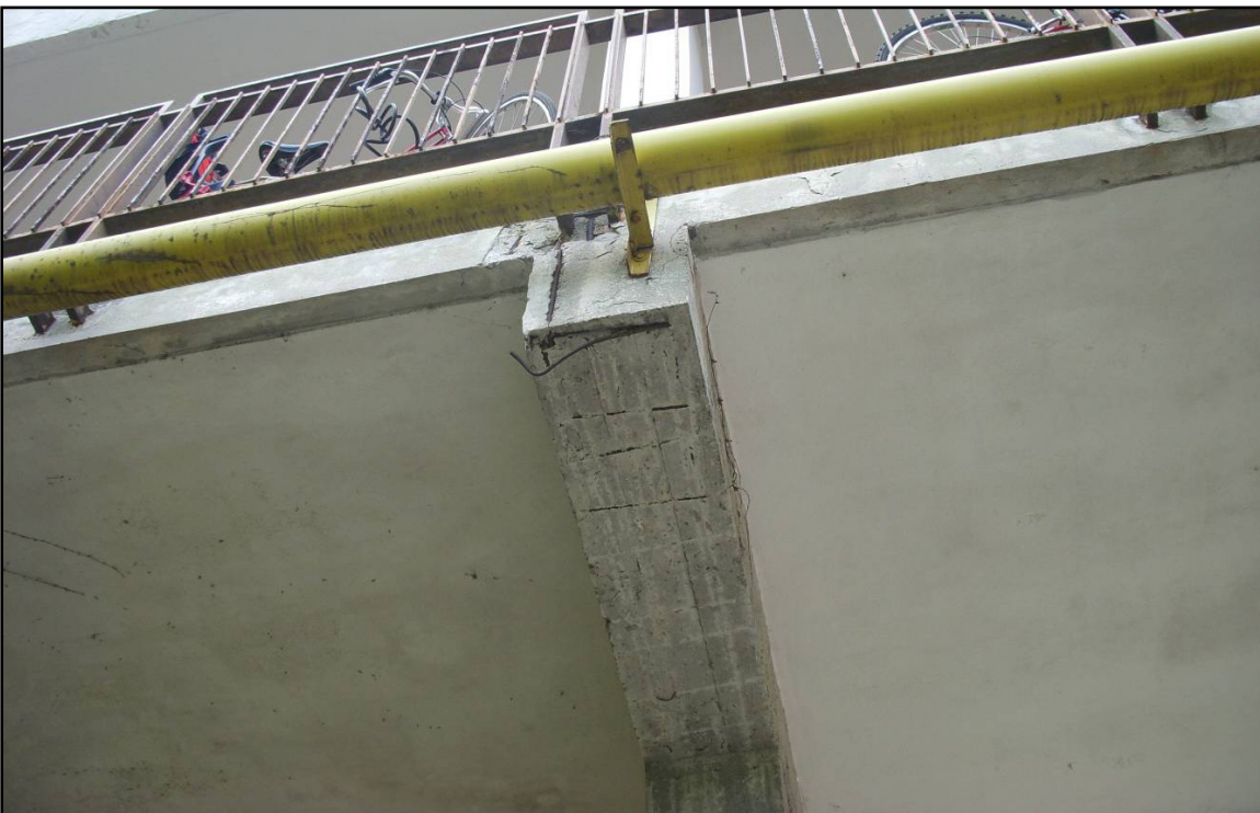
Figura 14 - Degrado del calcestruzzo e corrosione armature in corrispondenza dei sostegni del porticato di accesso
