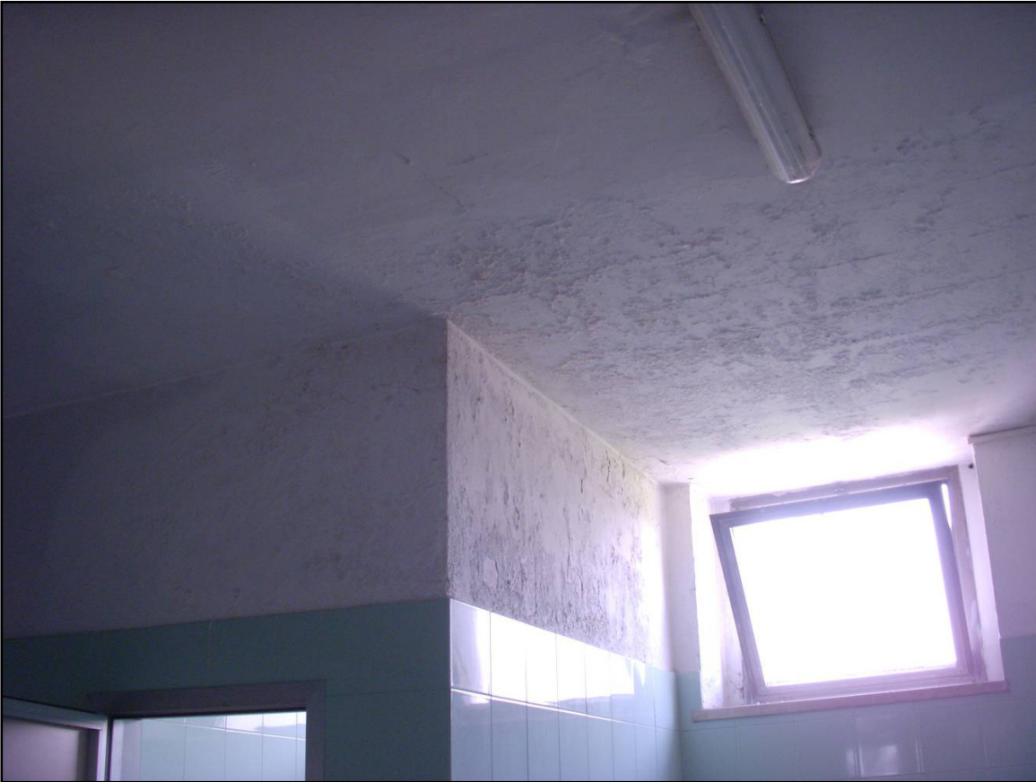
Figura 11 - Residui di umidità dovuto a perdita di tubazione acqua
