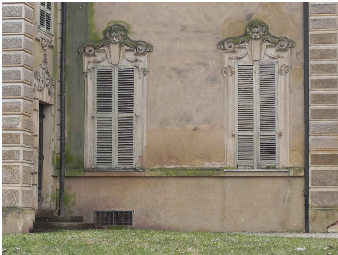
Macchie di umidità sull'intonaco del piano primo.
