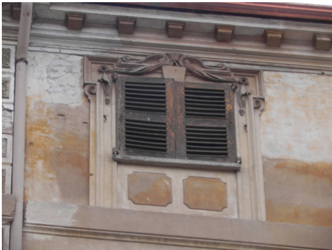
Macchie di umidità del piano terzo.
