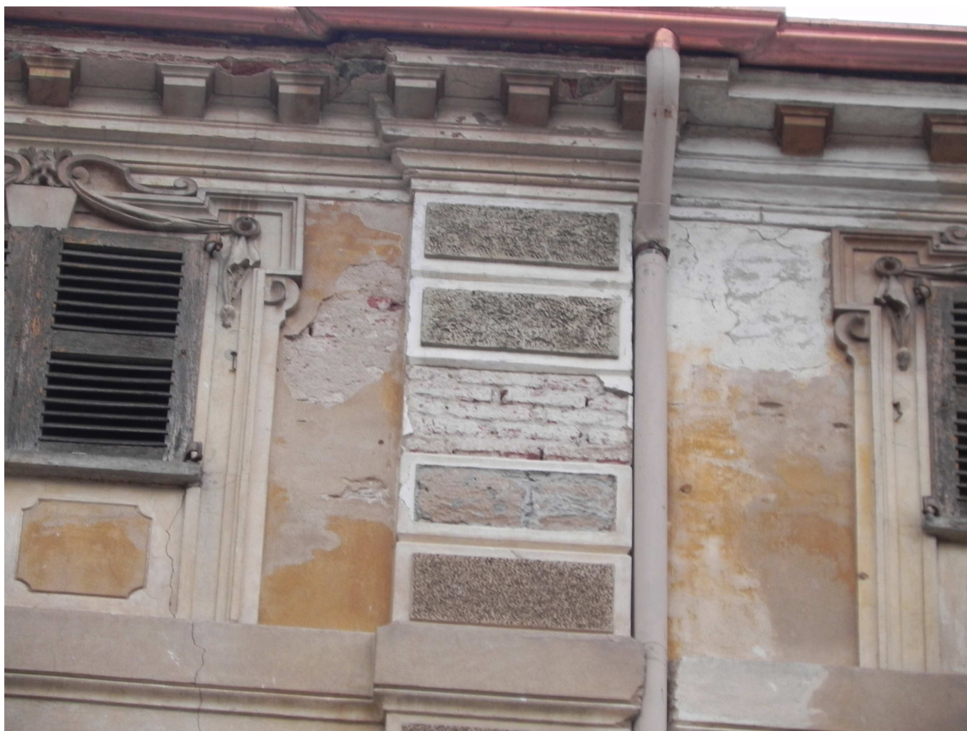
Particolare del degrado su intonaci, cornicione e bugne del piano terzo.
