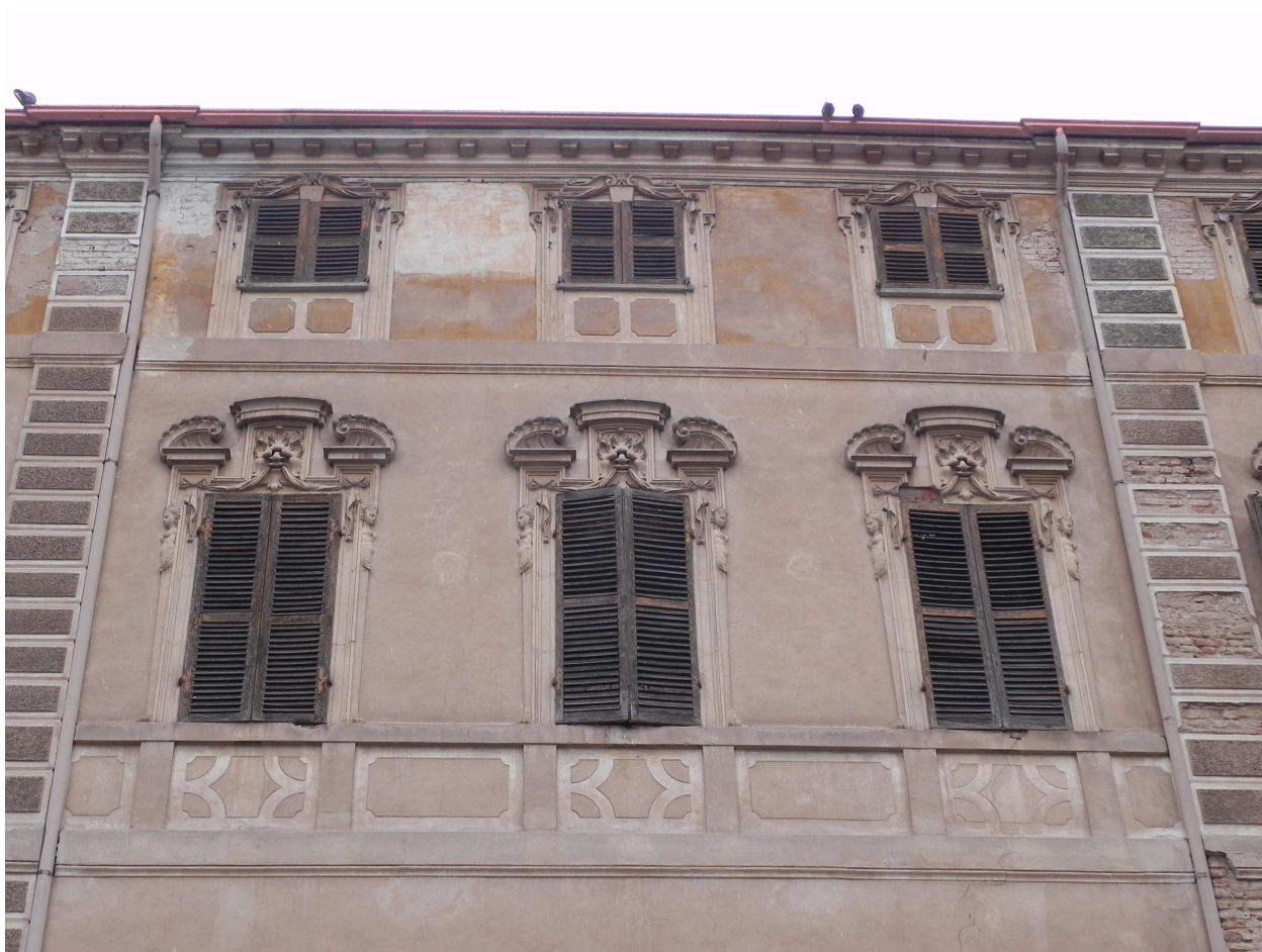
Particolare del degrado del piano secondo e terzo.
