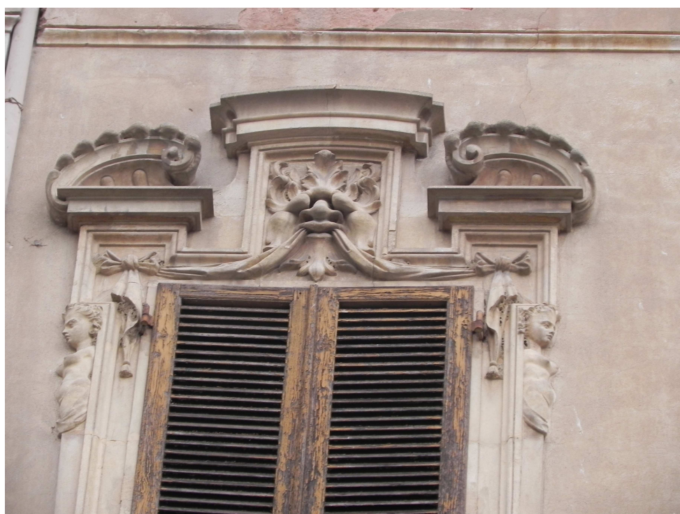
Particolare del calco sopra le finestre del piano secondo e del degrado delle persiane lignee.
