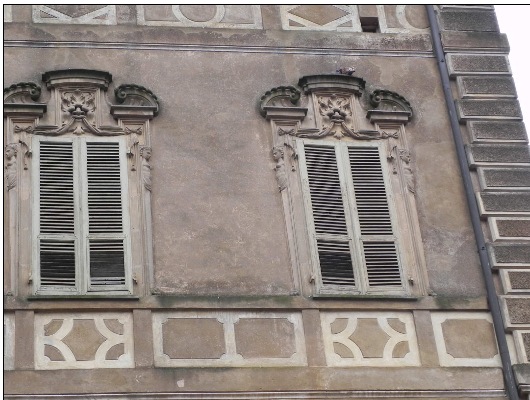
Particolare del degrado su intonaci, calchi e persiane.
