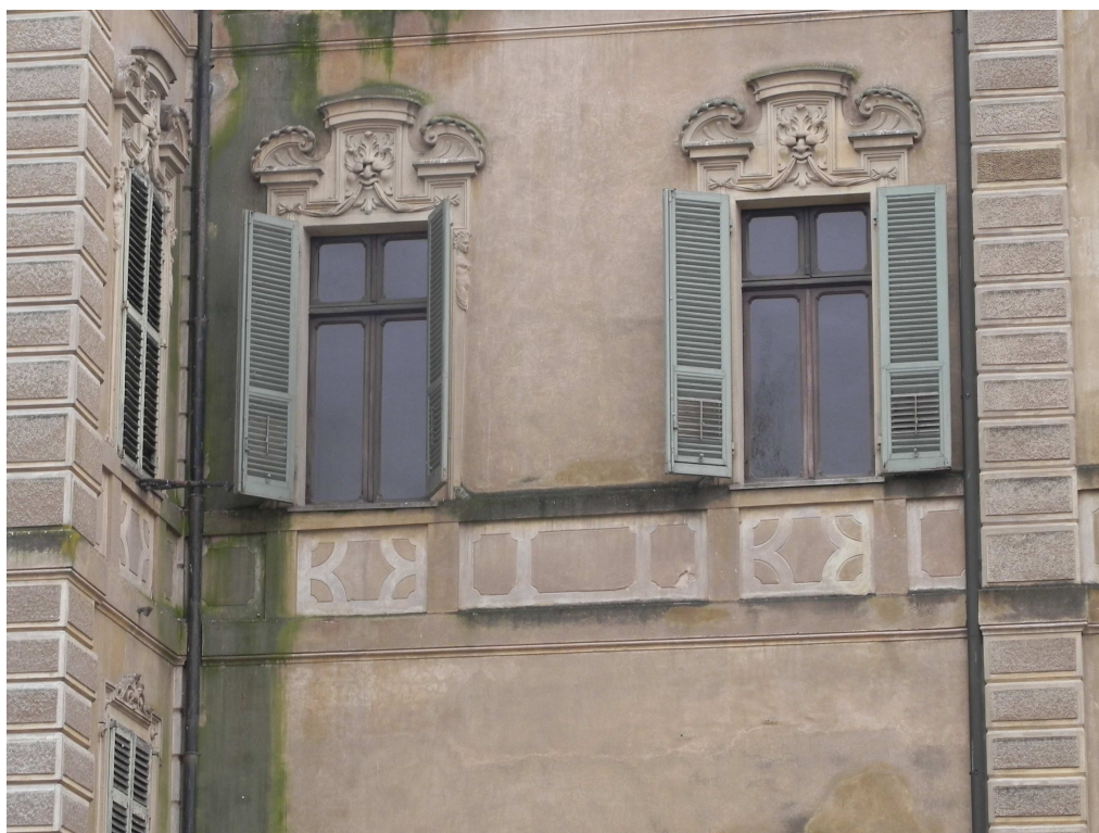
Macchie di umidità sull'intonaco del piano secondo.
