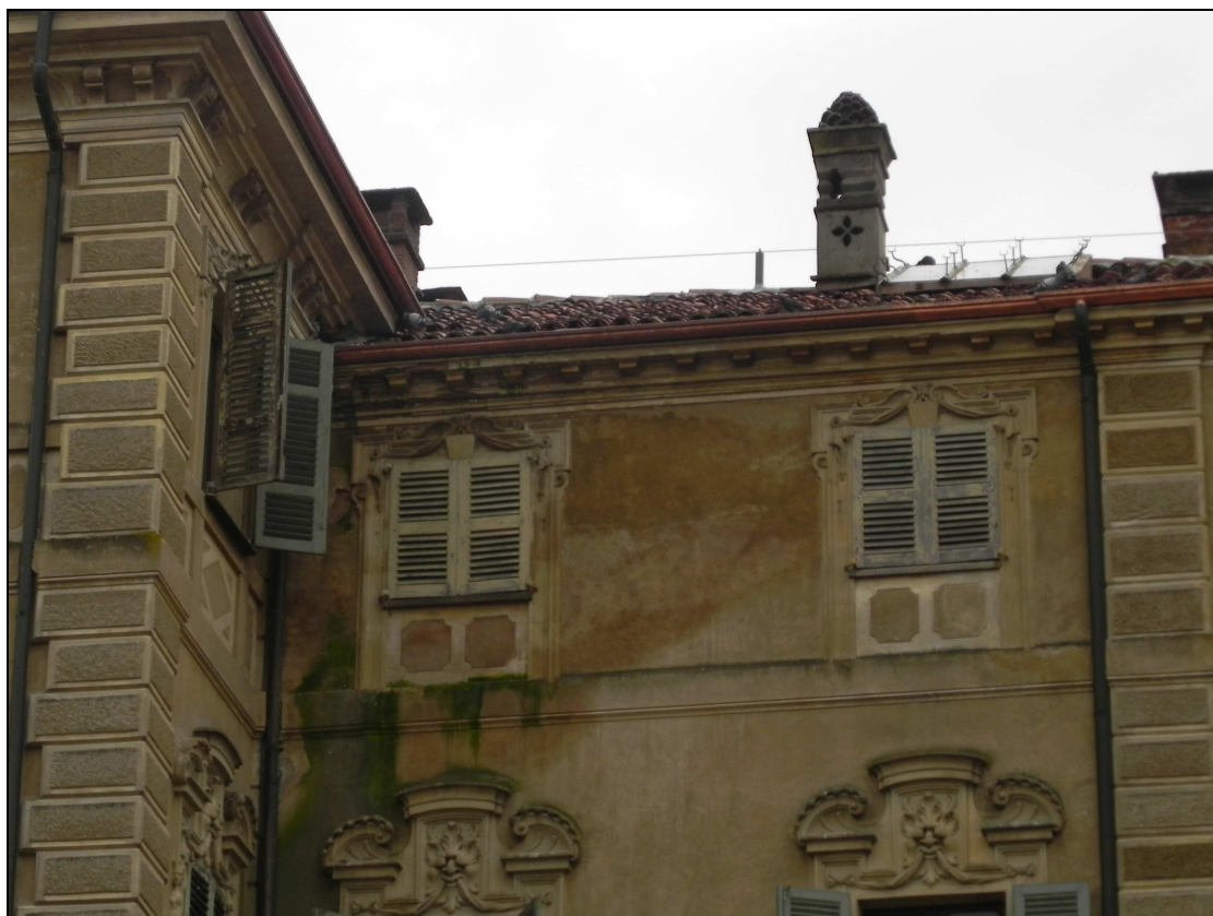
Macchie di umidità sull'intonaco del piano terzo.
