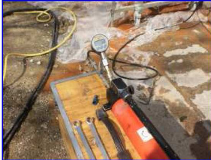
La pompa ed il manometro utilizzati
