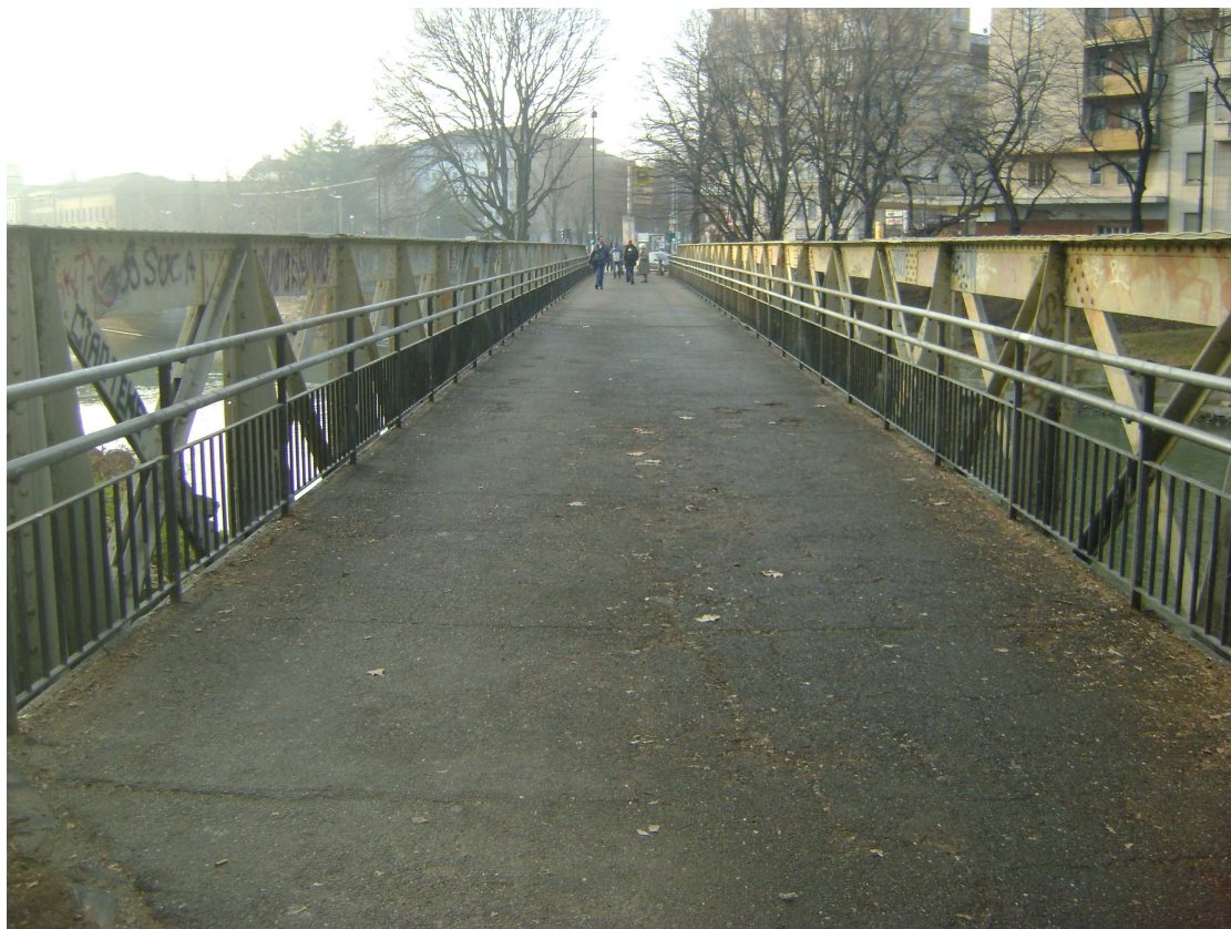
Messa in sicurezza sponde tra ponte via Bologna e ponte Mosca sulla Dora
