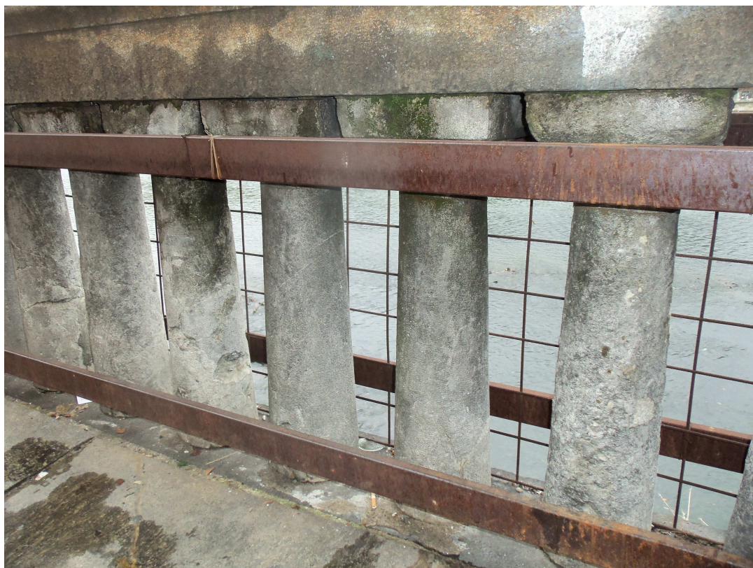
foto 11 colonnine erose e lesionate nel modulo 81
