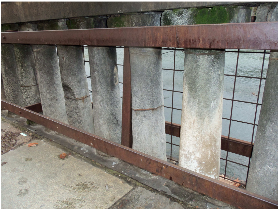
foto 07 colonnine erose nel modulo 77
