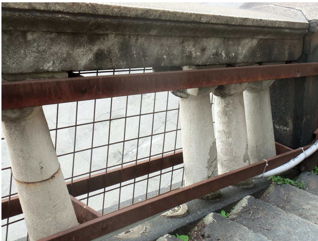
foto 46 colonnine mancanti nel "modulo L - scala C"
