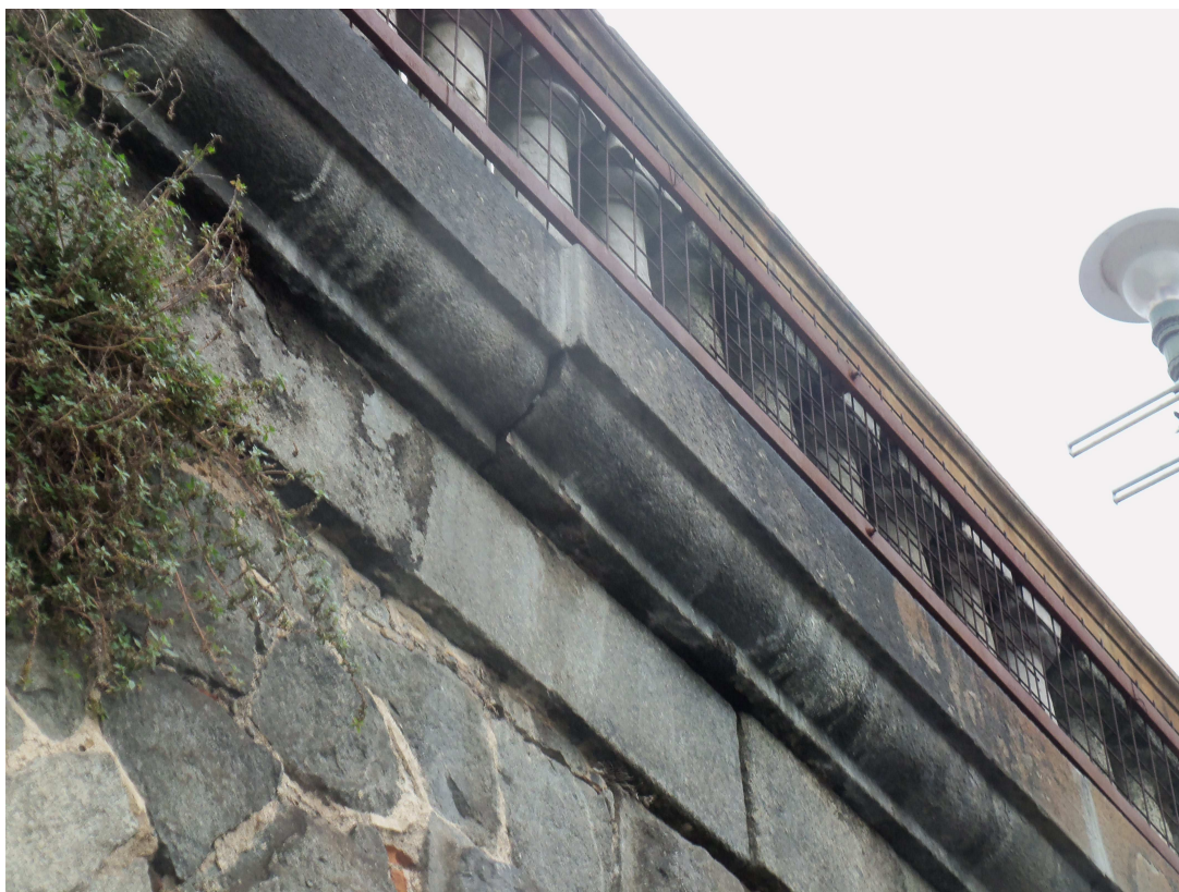
foto 24 cornice sconnessa in corrispondenza del modulo 90
