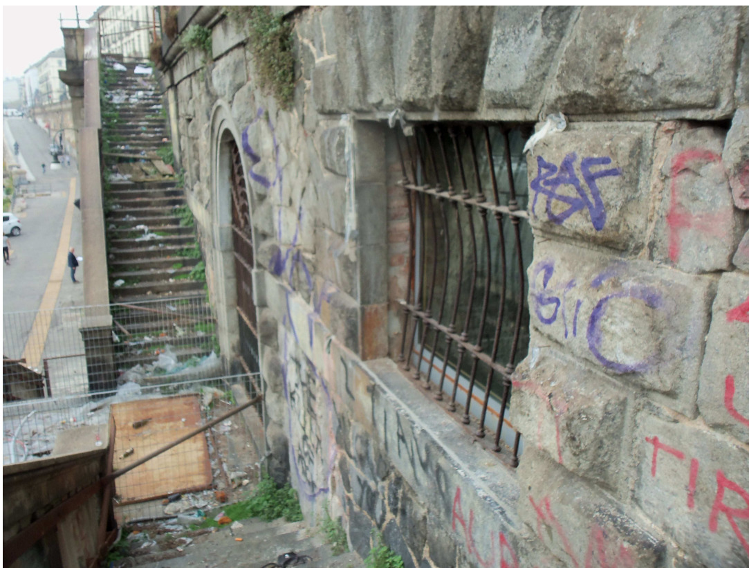
foto 48 grata metallica da sostituire
