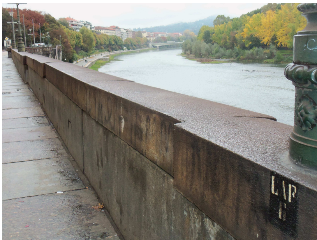
foto 04 lastroni sconnesso tra pilastro E e F
