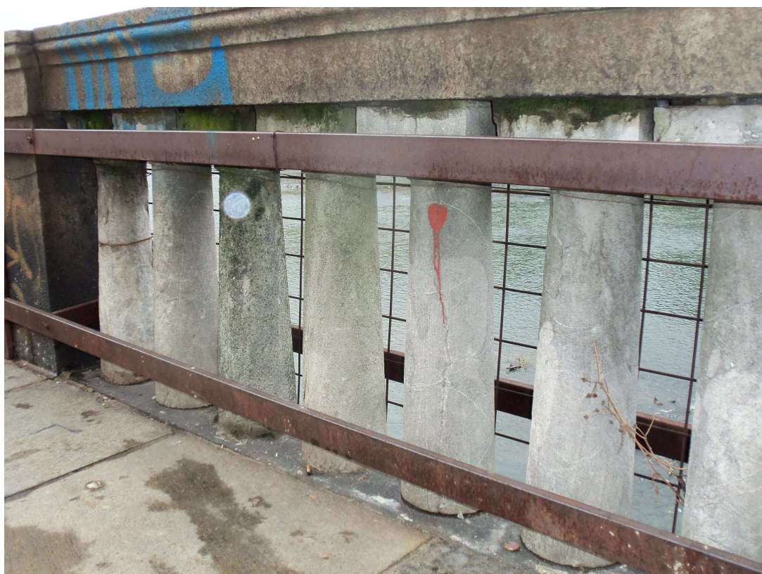
foto 12 colonnine lesionate superficialmente, in cls ed erosa nel modulo 83
