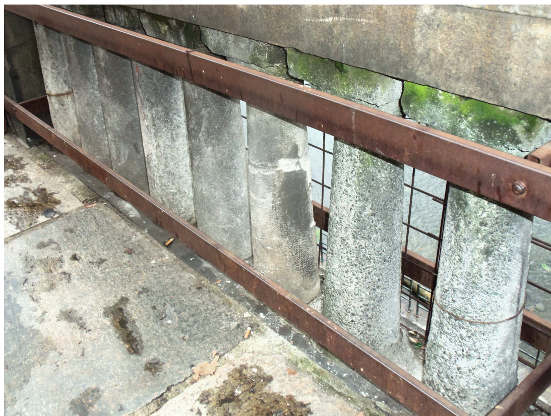
foto 08 colonnine erosa, rotta e in cls nel modulo 77
