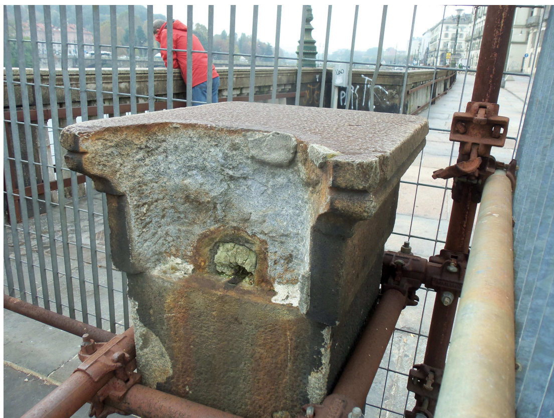
foto 16 pilastrino 86/scala C
