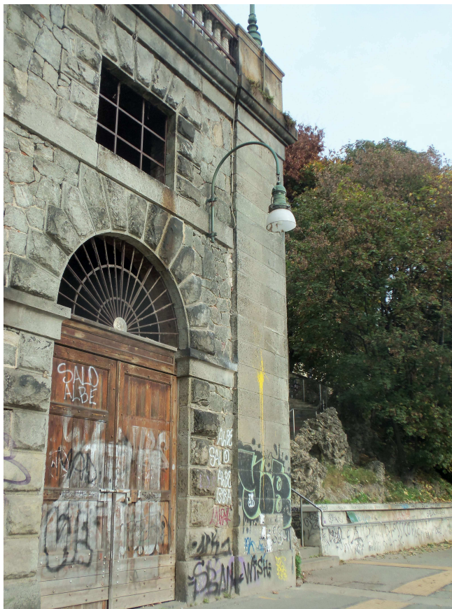
foto 29 parete in corrispondenza del modulo 93
