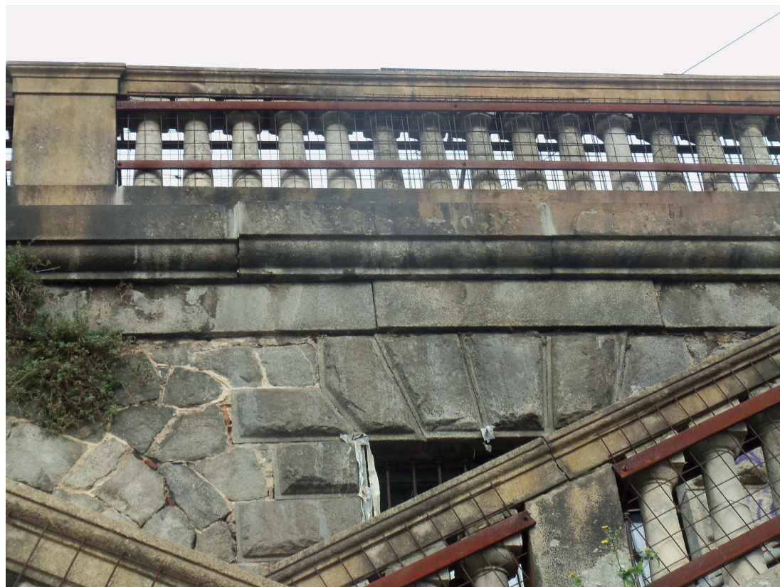
foto 26 cornice sconnessa in corrispondenza del modulo 90
