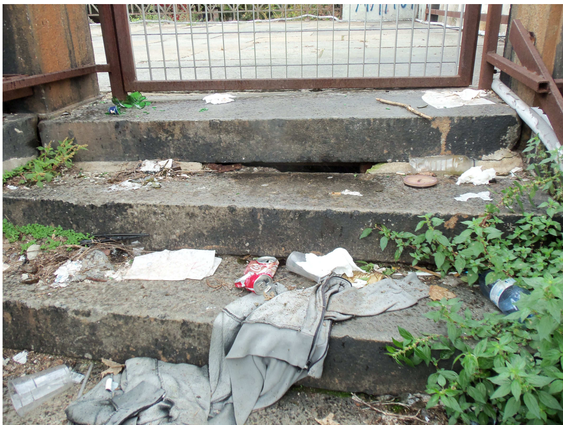
foto 45 vista gradino sconnesso in corrispondenza del "modulo I – scala C"
