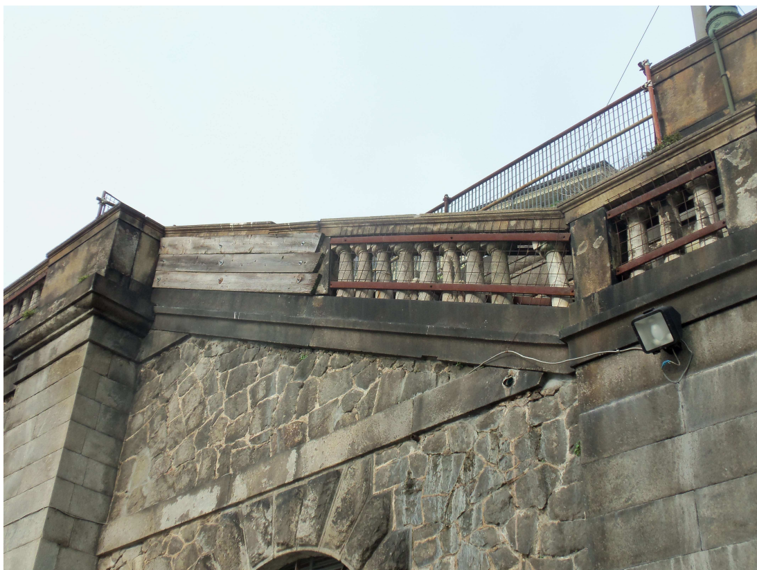
foto 33 vista scala C – modulo a mancante
