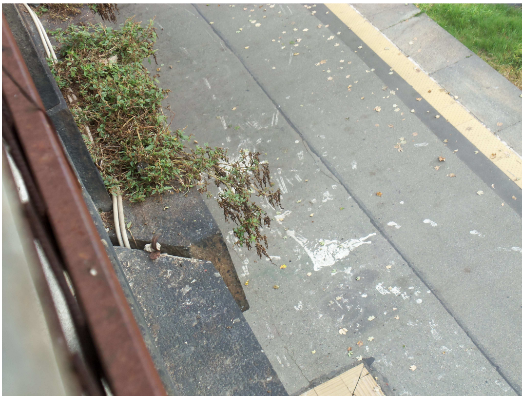
foto 31 lastra sconnessa nella cornice del pilastrino angolare
