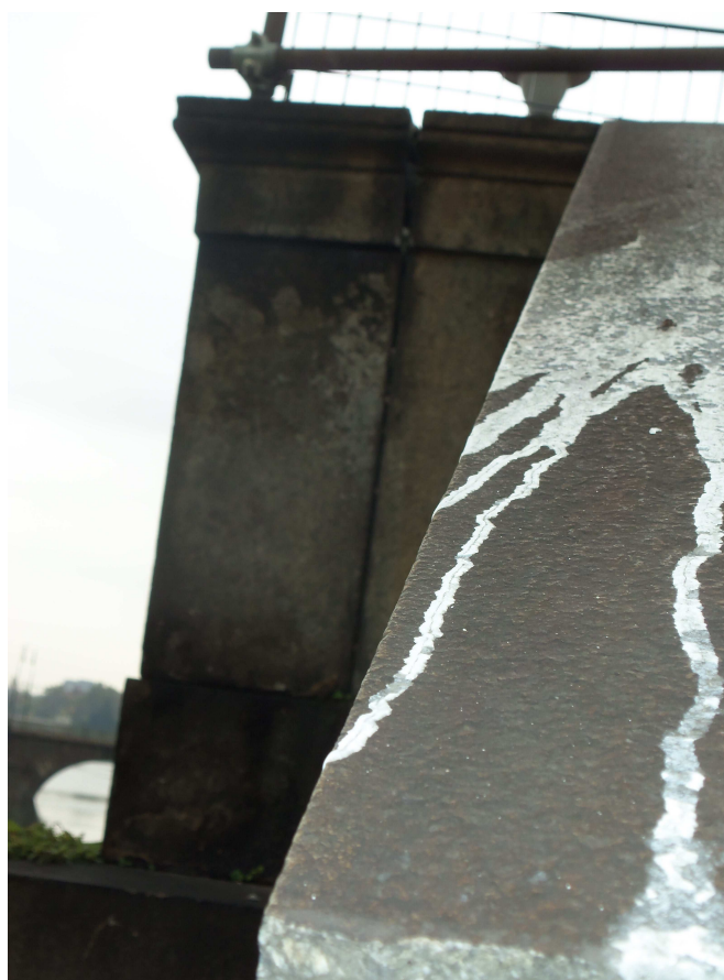
foto 14 lastroni angolari distaccati sul pilastro 85/scala
