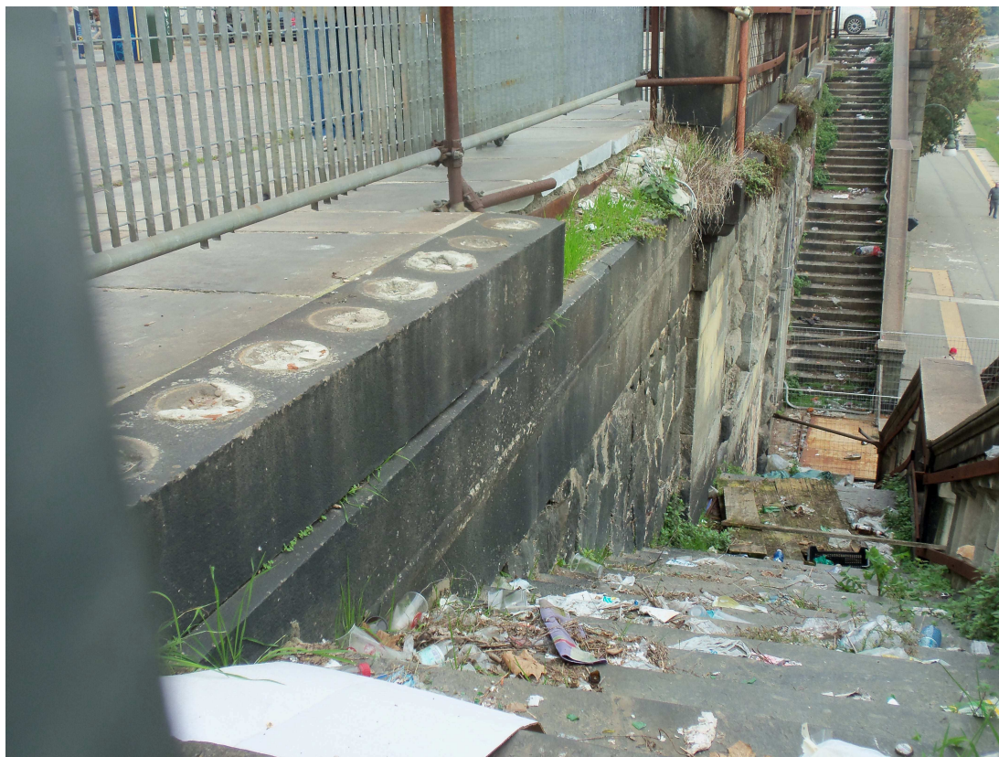
foto 15 vista moduli 86 e 87 mancanti
