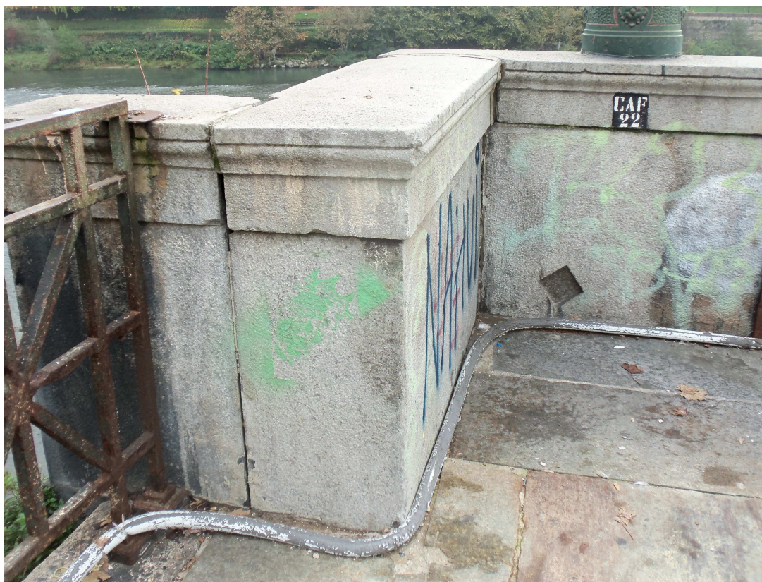
foto 32 mancorrenti angolari sconnessi
