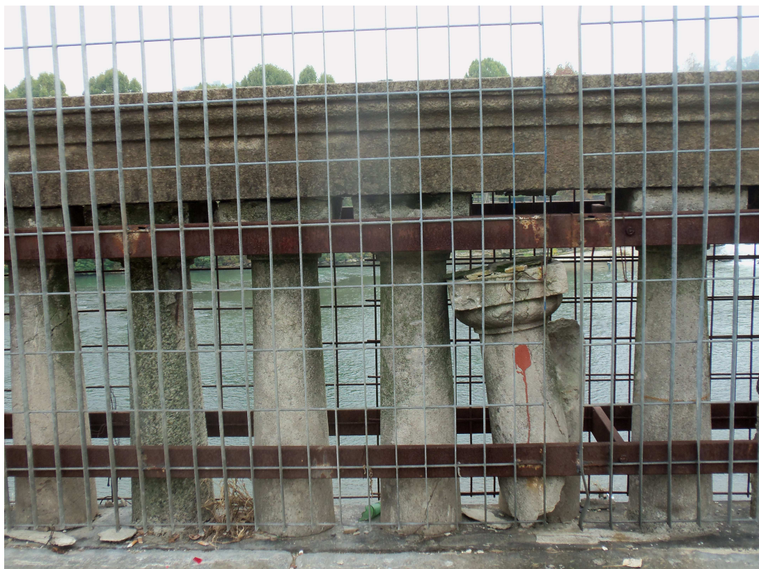
foto 19 colonnina rotta nel modulo 88
