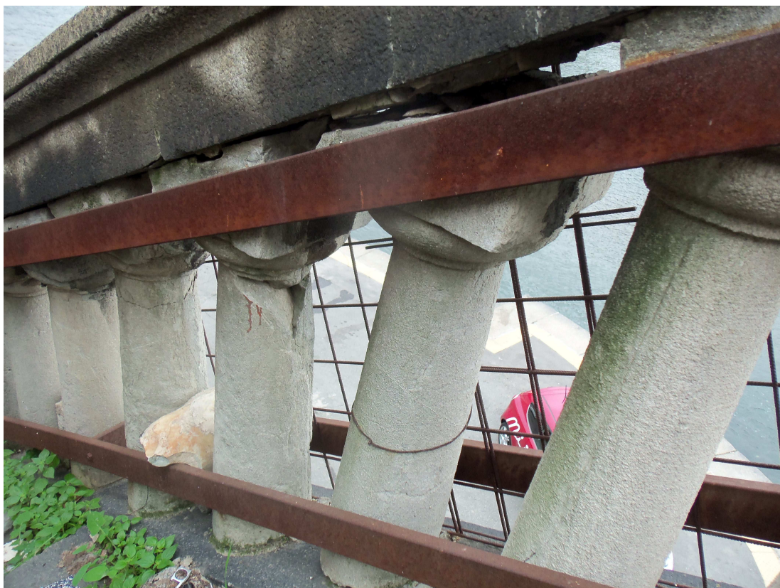
foto 36 colonnina rotta del "modulo B – scala C"
