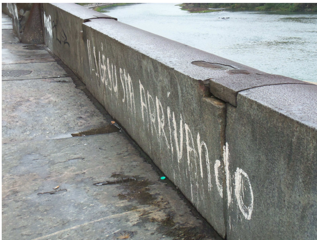
foto 02 lastrone sconnesso tra pilastro D e E
