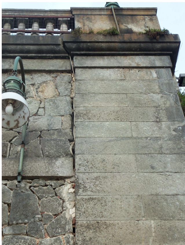
foto 30 particolare del distacco tra pilastro e parete in corrispondenza del modulo 93
