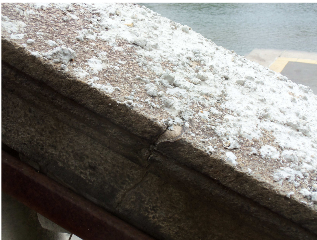
foto 40 cima lesionata e sporca di cls nel "modulo H - scala C"
