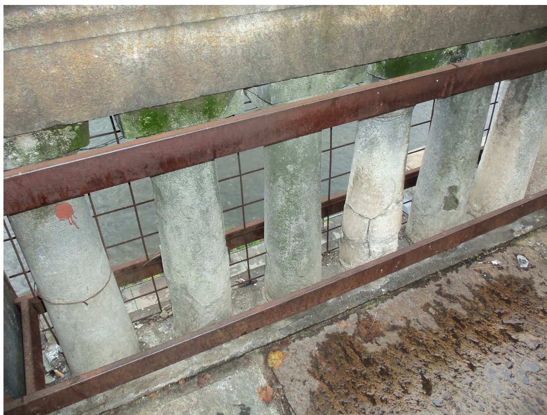
foto 06 colonnine erose e lesionate nel modulo 76
