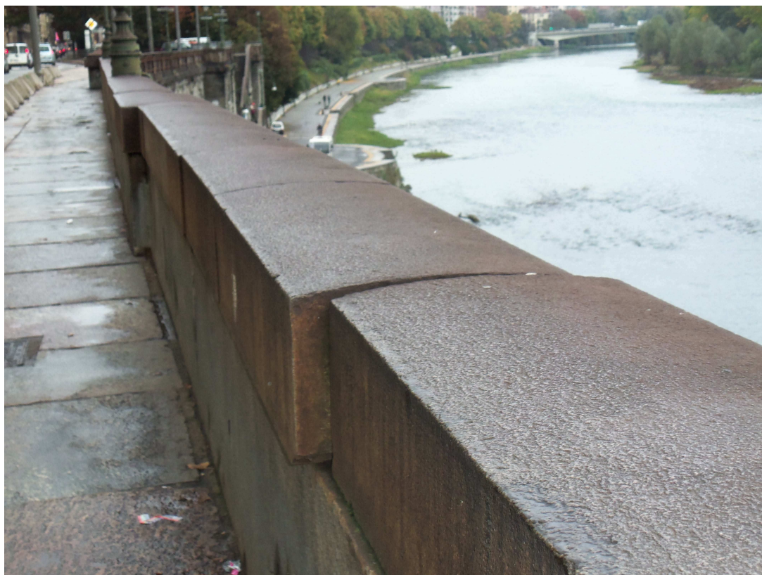
foto 05 lastroni sconnesso tra pilastro E e F
