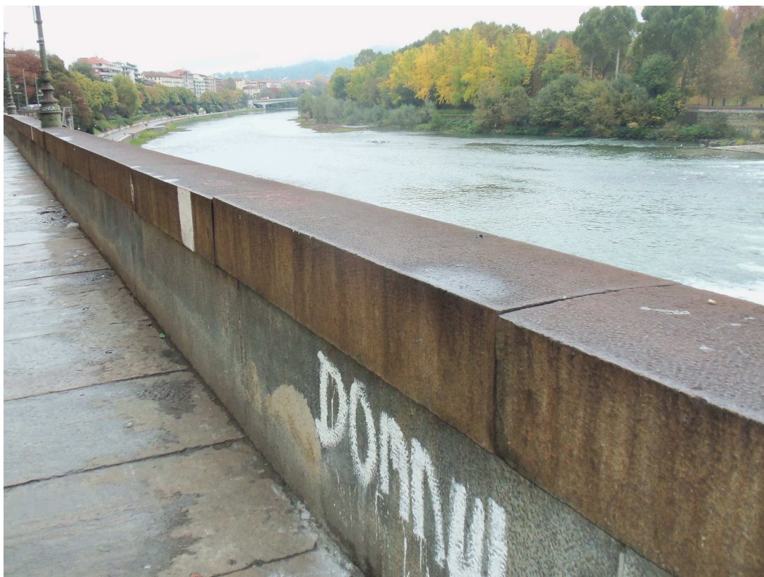
foto 03 lastroni sconnesso tra pilastro E e F
