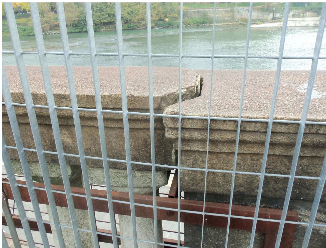
foto 18 cimasa modulo 88 sconnessa con pilastro 87/88
