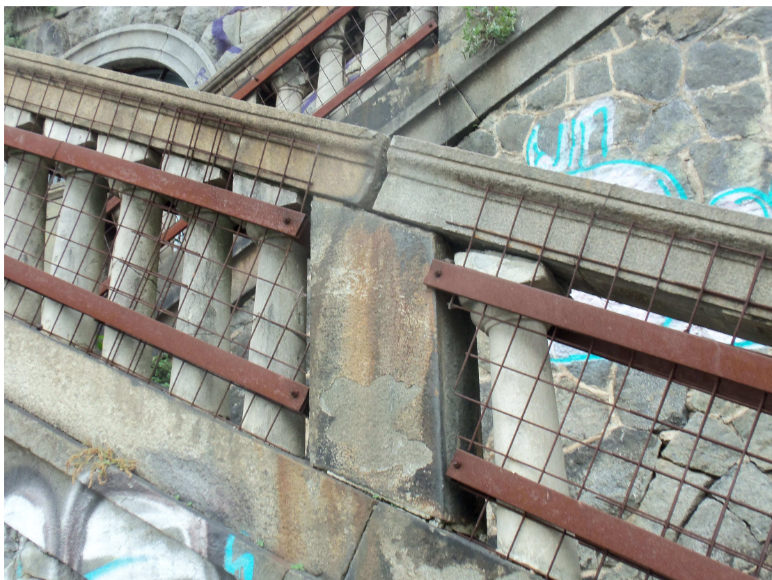
foto 52 cimasa del “modulo Q – scala C” sconnessa e scivolata
