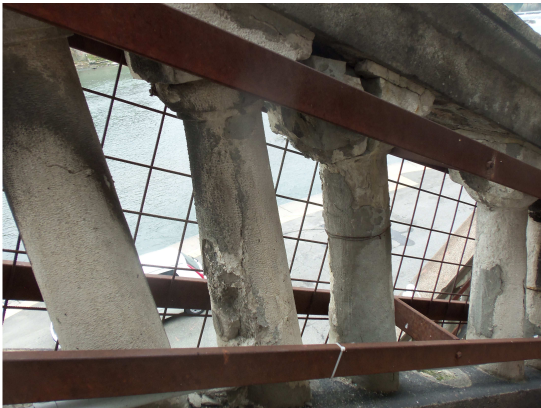
foto 47 colonnine rotta ed erose nel "modulo N-scala C"
