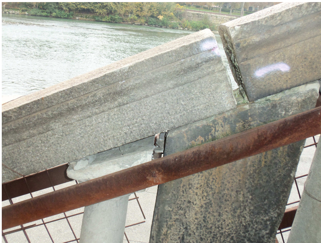
foto 51 cimasa del “modulo Q – scala C” sconnessa e scivolata
