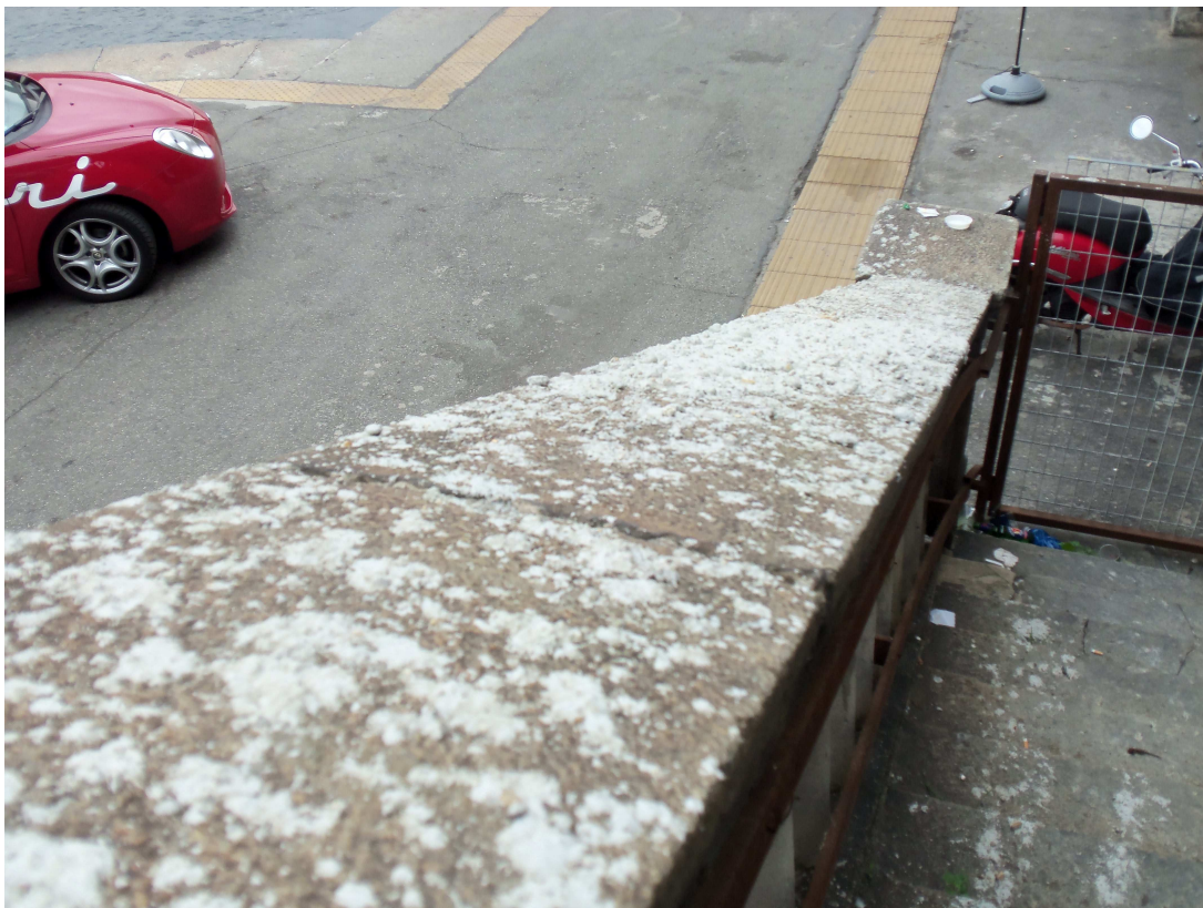
foto 39 cima lesionata e sporca di cls nel "modulo H - scala C"
