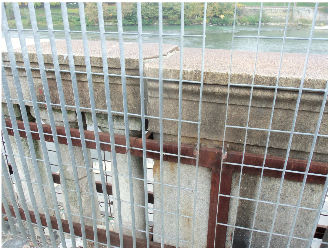
foto 23 cimasa del modulo 90 sconnesso con il pilastrino 89/90
