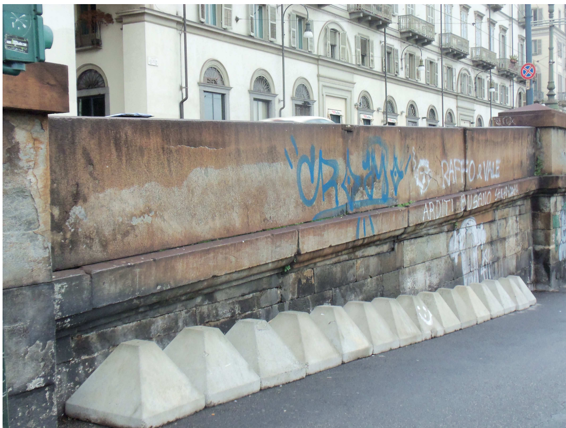
foto 01 lastrone sconnesso tra pilastro D e E
