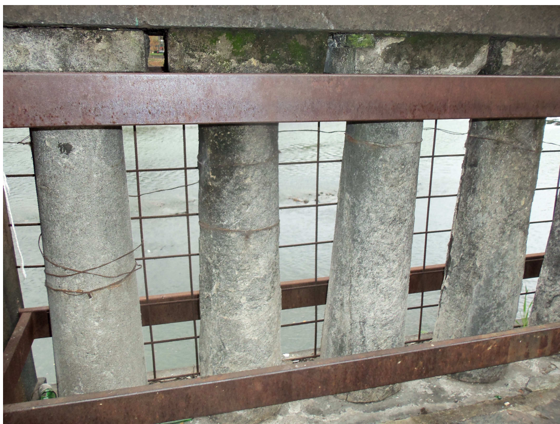
foto 10 colonnine erose nel modulo 80
