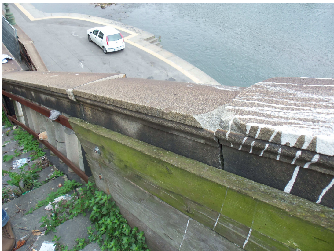
foto 34 cima rota del "modulo A-scala C"
