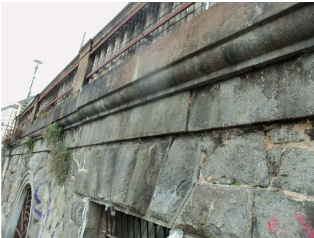
foto 25 cornice sconnessa in corrispondenza del modulo 90
