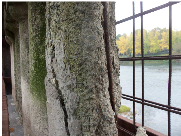
colonnina in cls nel modulo 89
