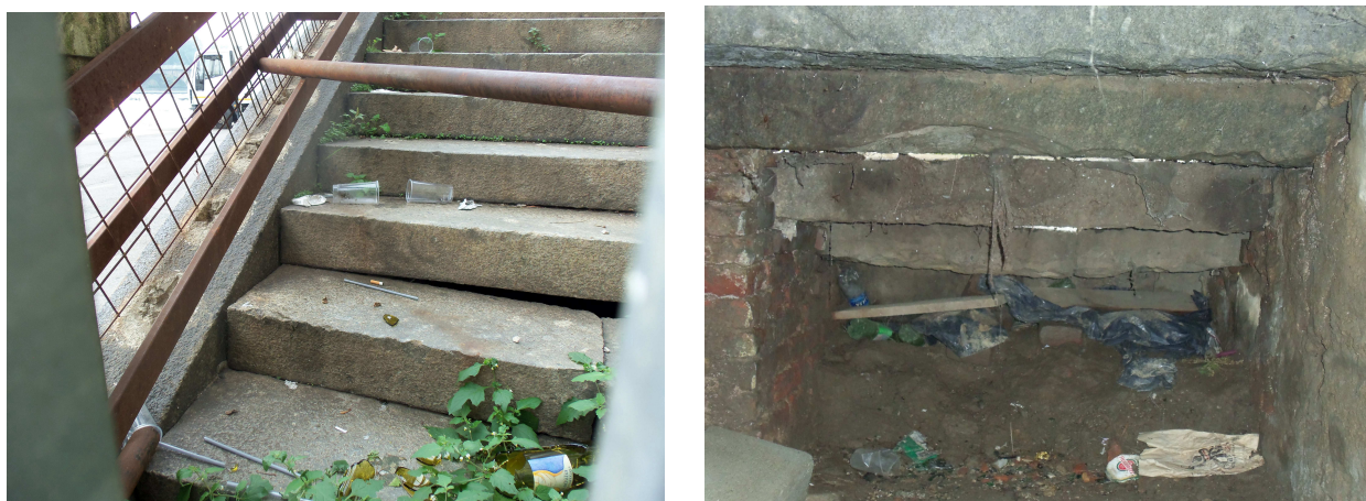
vista esterna e sottorampa dei gradini rotti nella prima rampa a salire in corrispondenza del “modulo q – scala C”
