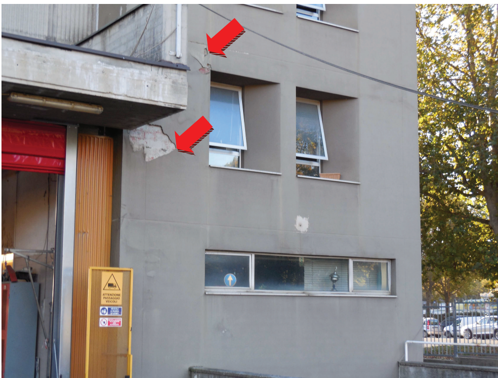
Foto 7 – Intonaci delle facciate ammalorati (zona uffici – zona SAF)
