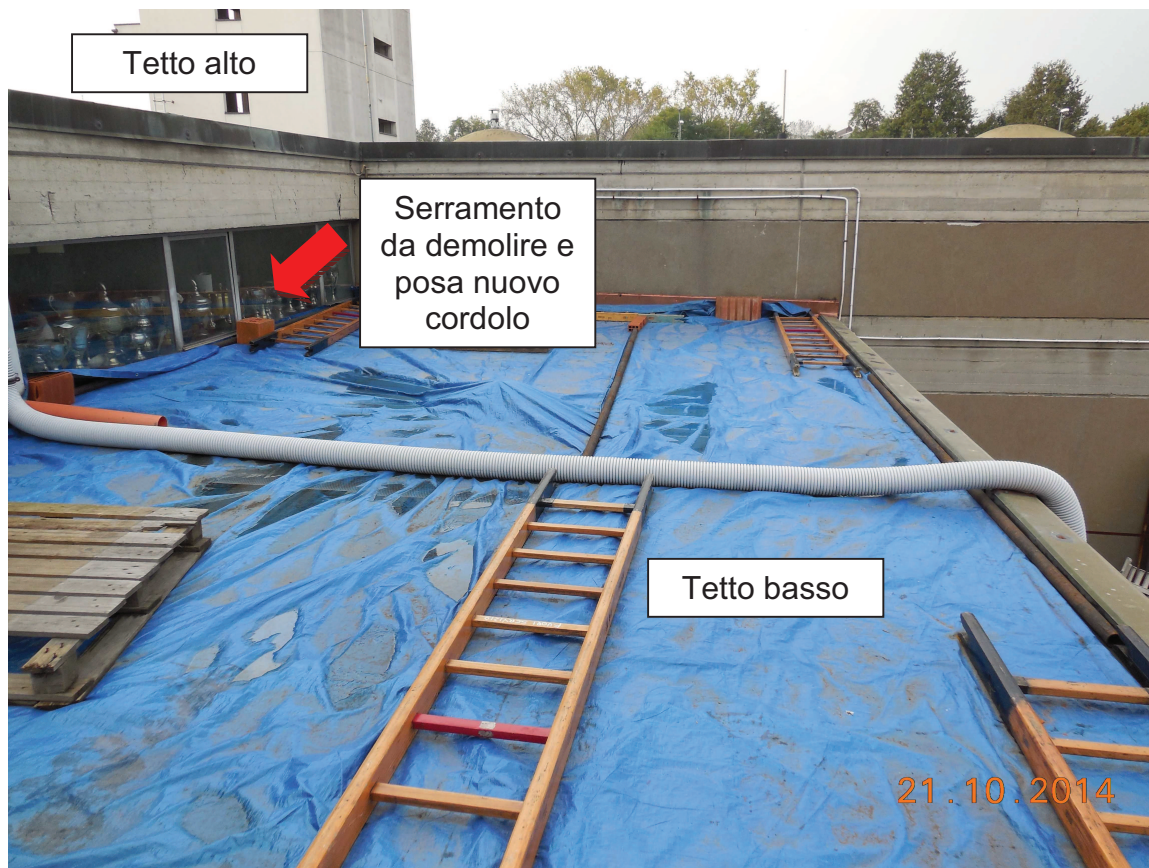
Foto 4 – Palestra pesi – Serramento da sostituire sul tetto basso
