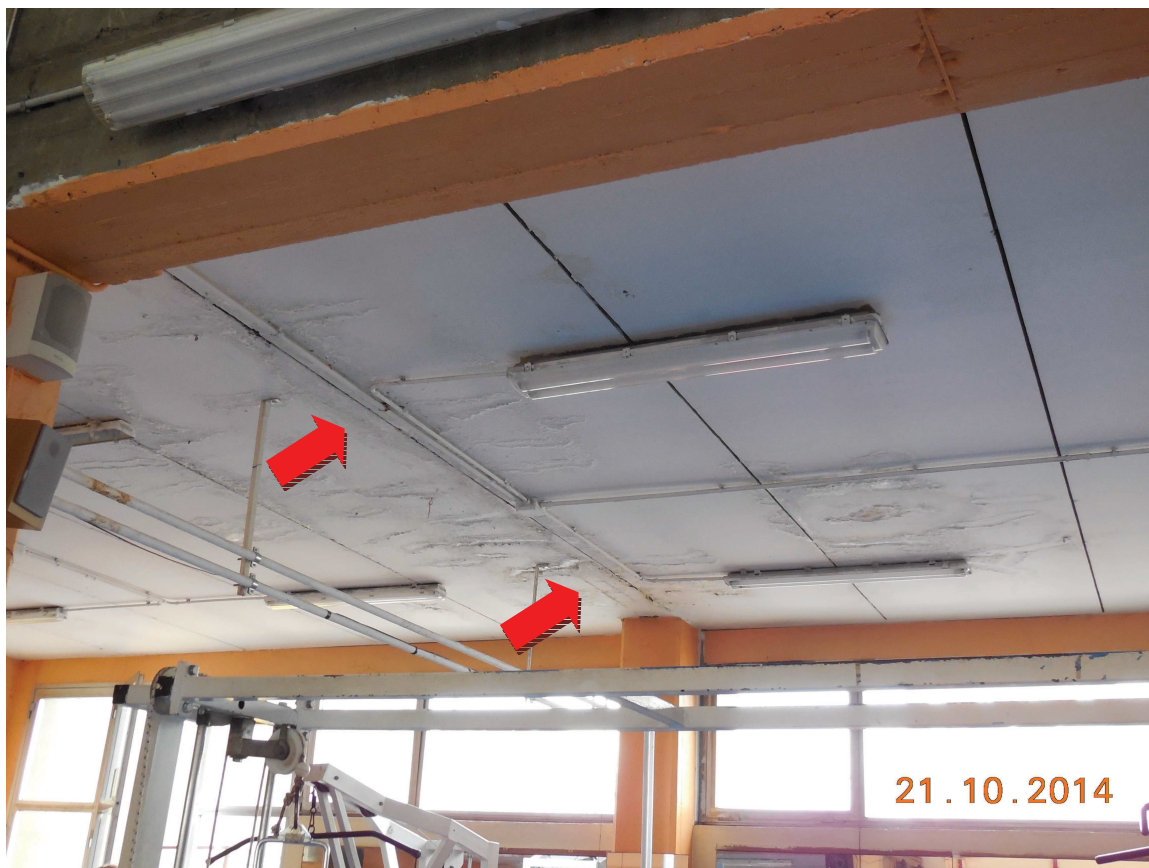
Foto 1 – Palestra pesi – Infiltrazioni a soffitto
