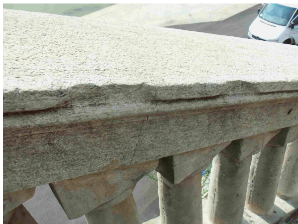
cimasa lesionata nel modulo B - scala B
