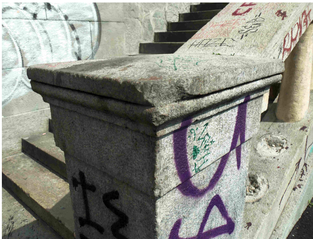
foto 83 angoli rotti della sommità del pilastro finale del modulo R della scala B
