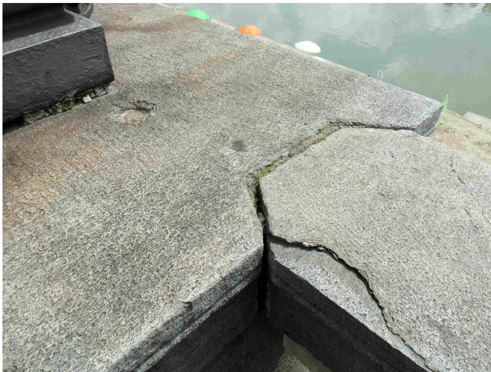
foto 45 cimasa 40 e pilastro 40/41 sconnessi
