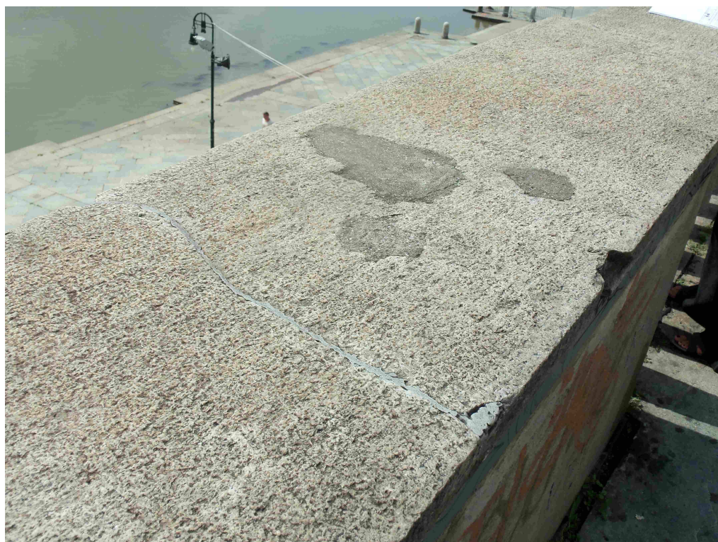
foto 70 lesione e parti mancanti della sommità del pilastro 62/63
