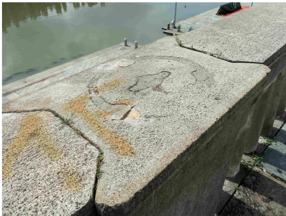
foto 65 angoli rotti del pilastro 59/60
