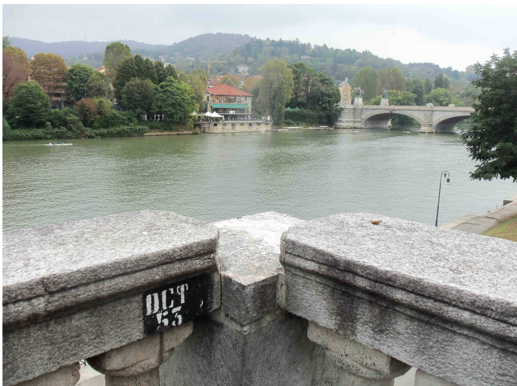
foto 03 capitello del pilastro2/3 mancante
