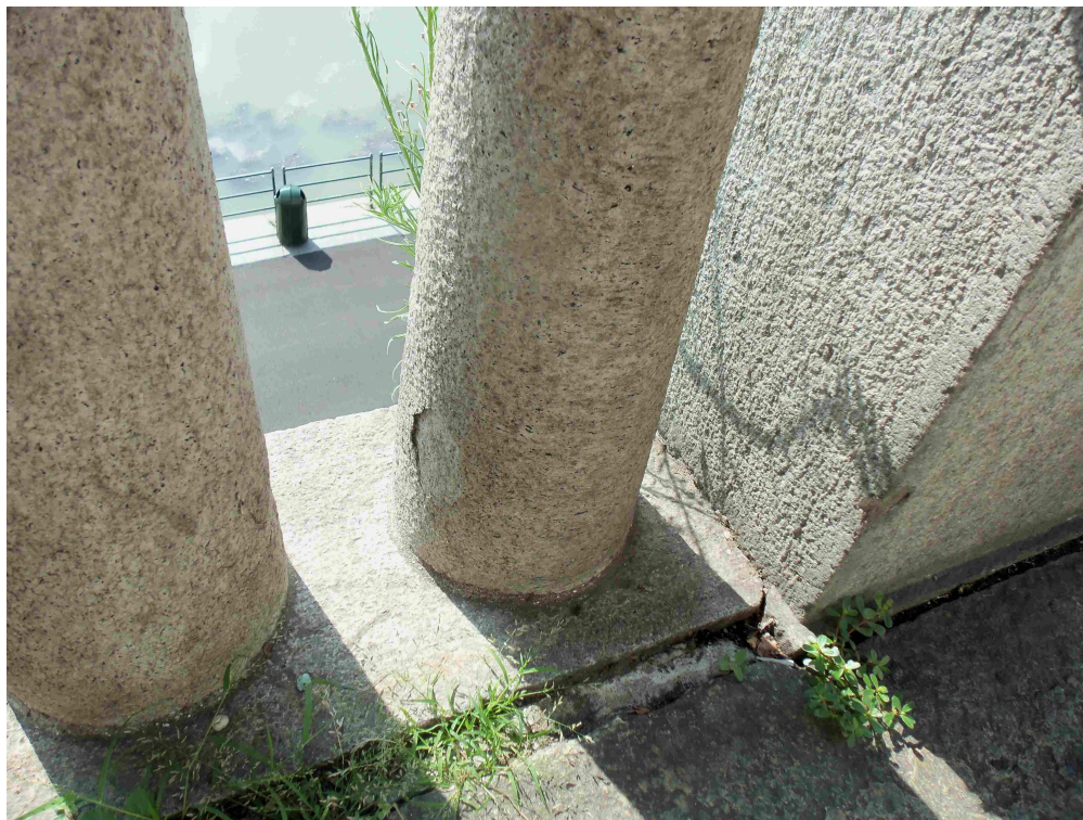
foto 85 esempio di colonnina sfogliata nel modulo 70
