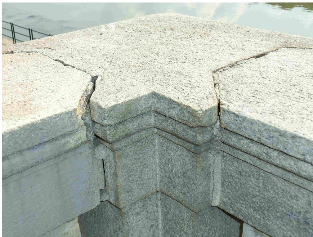
foto 82 cimase dei moduli O e P della scala B e pilastro intermedio sconnessi
