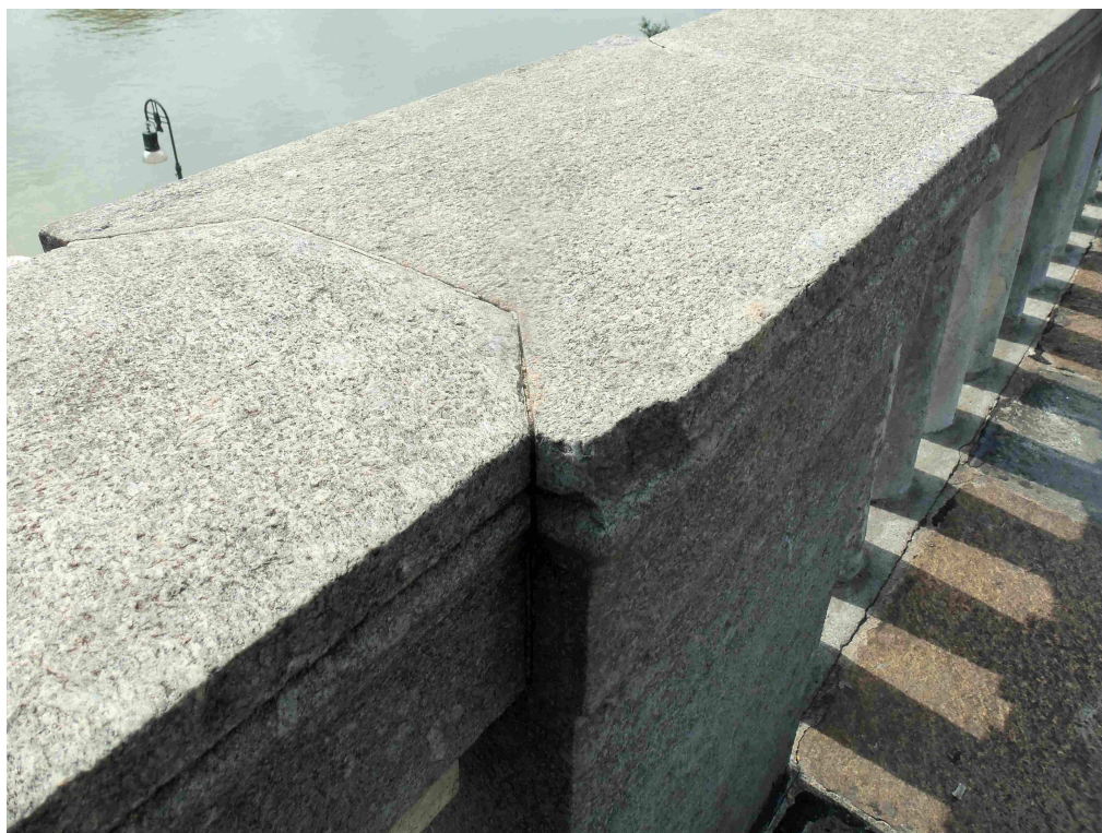
foto 59 angoli rotti del pilastrino 46/47
