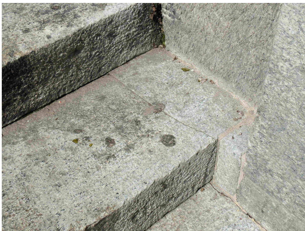
foto 76 8° gradino a salire della H della scala B lesionato
