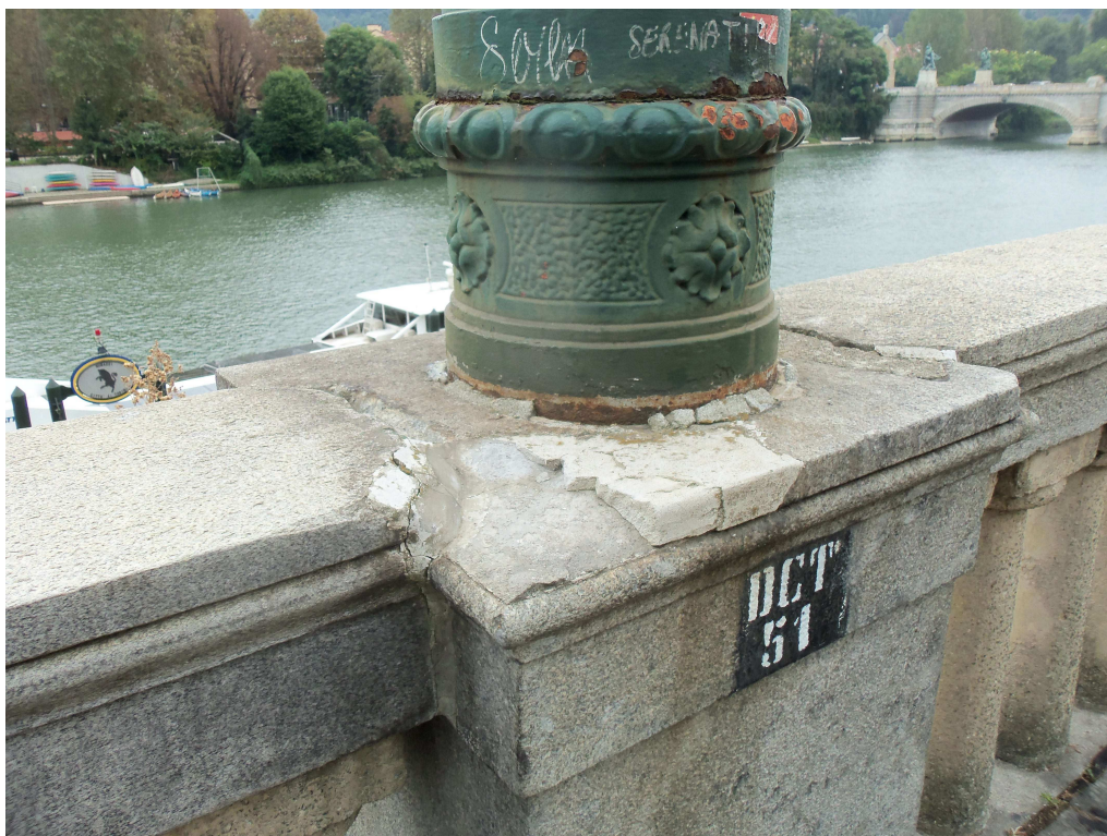
foto 05 sigillature in cls e parti mancanti del capitello e degli angoli del pilastrino 5/6
