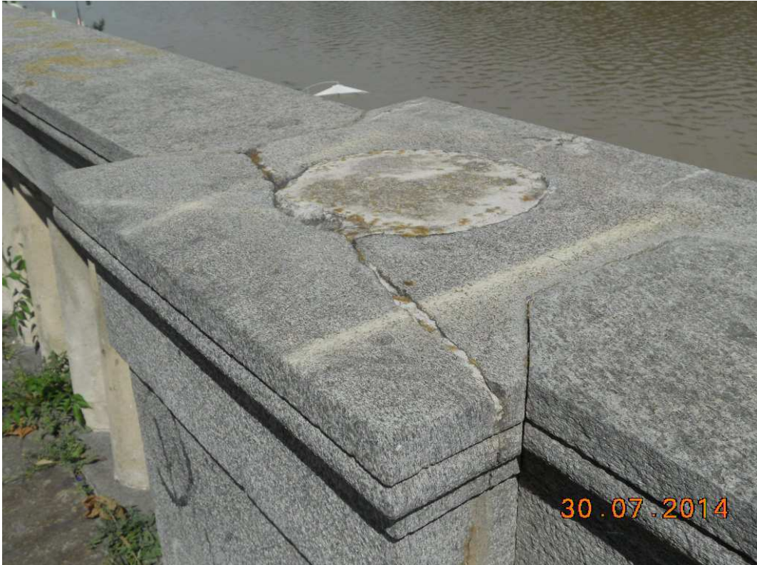
foto 31 lesione alla sommità del pilastro 26/27
