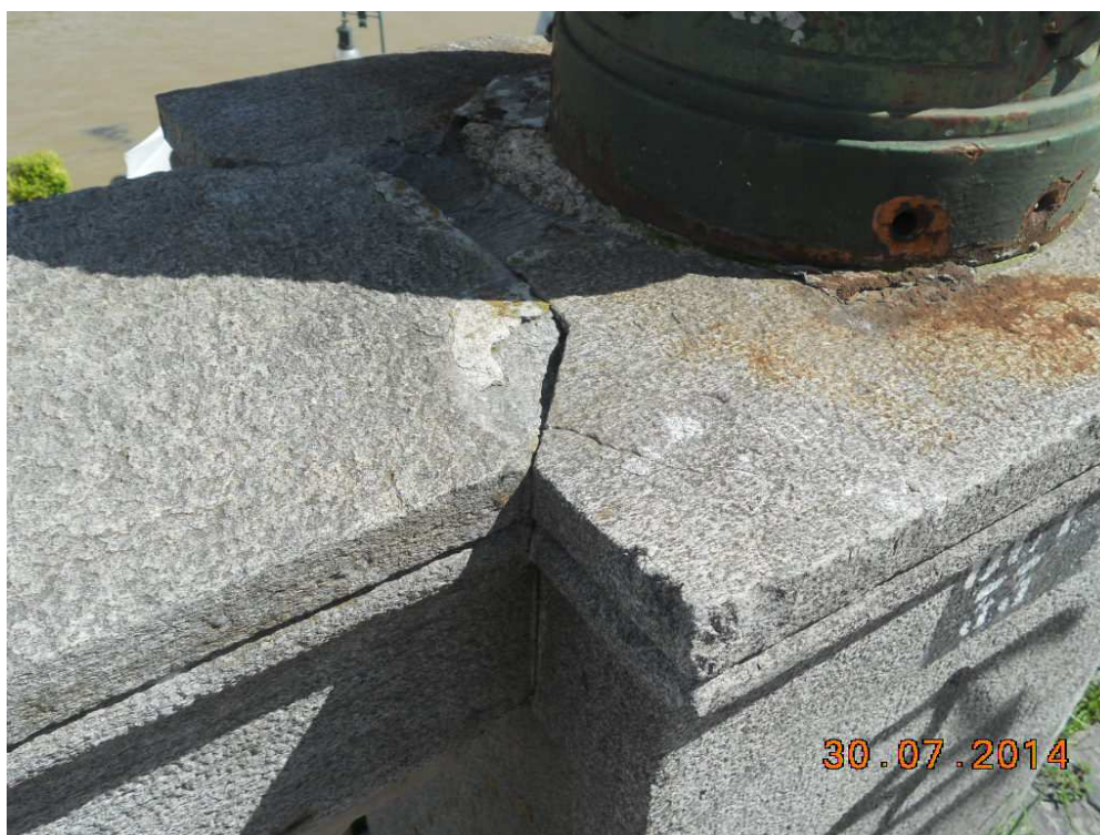
foto 34 piccole parti mancanti della cimasa del modulo 31 e del pilastro 30/31
