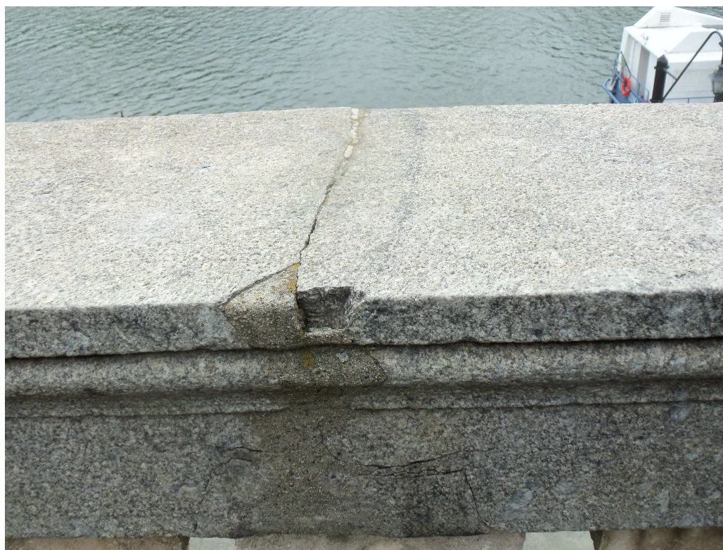
foto 08 lesione cimasa del modulo 12
