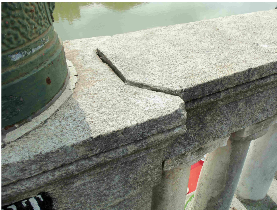
foto 49 cimasa 41 e pilastrino 41/42 sconnessi
