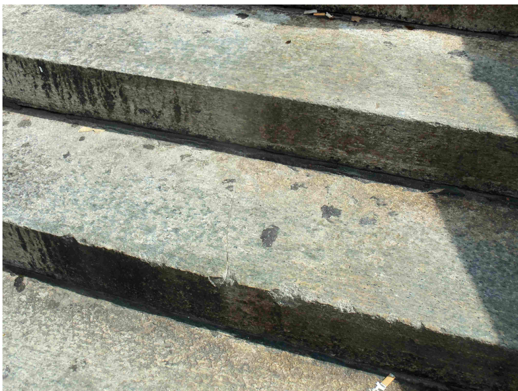
foto 72 2° gradino a scendere della rampa A/B della scala B lesionato
