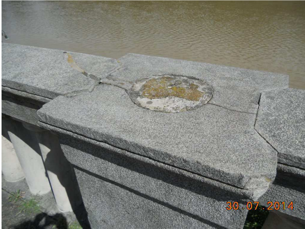
foto 37 lesioni della sommità del pilastro 32/33 e della cimasa 33
