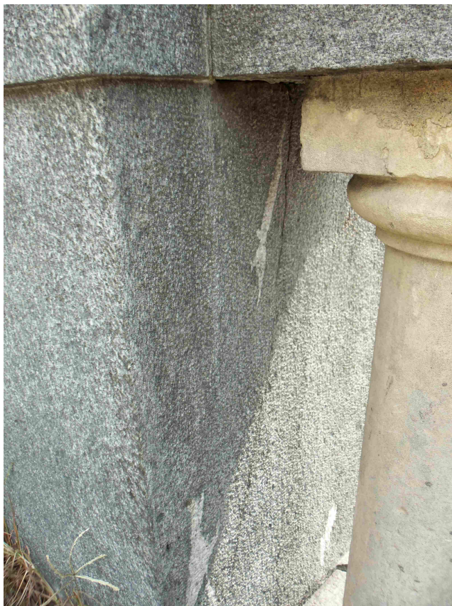
foto 41 lesioni laterali del pilastro 36/37
