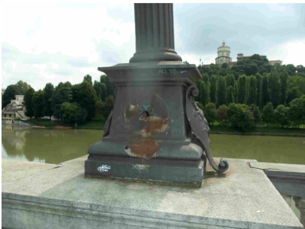
foto 46 stemma mancante al fumaiolo del pilastro 40/41
