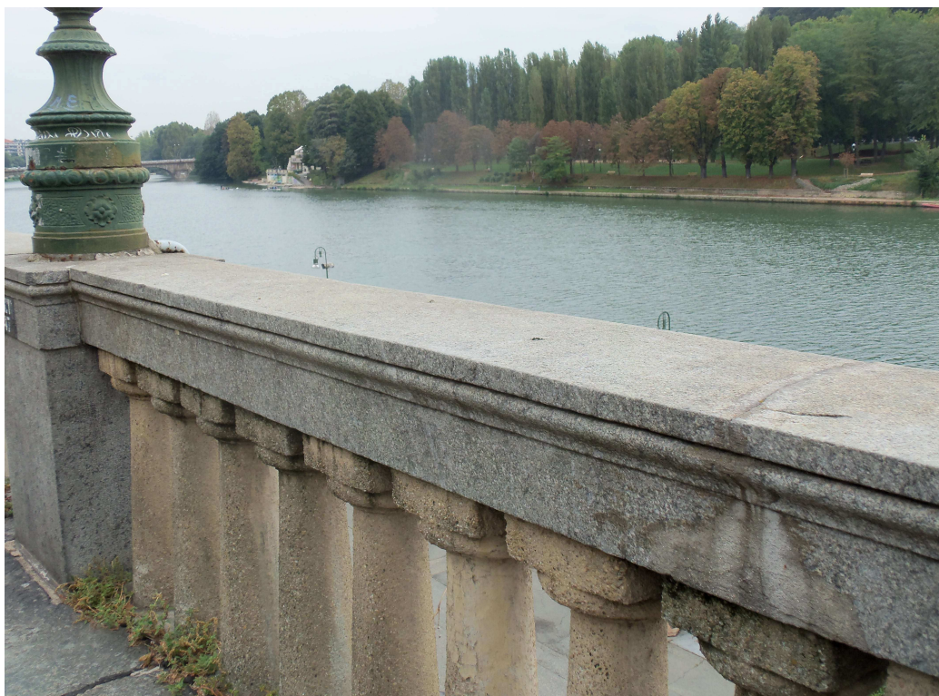
foto 07 lesione cimasa del modulo 11
