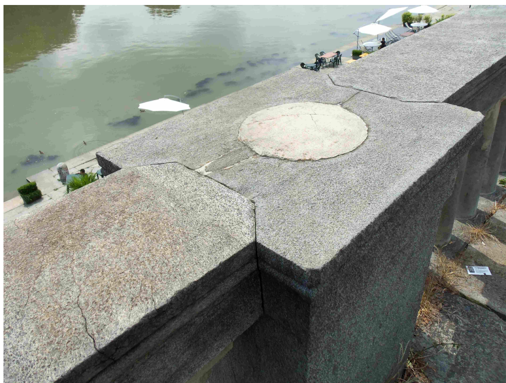
foto 42 lesioni in sommità del pilastro 36/37
