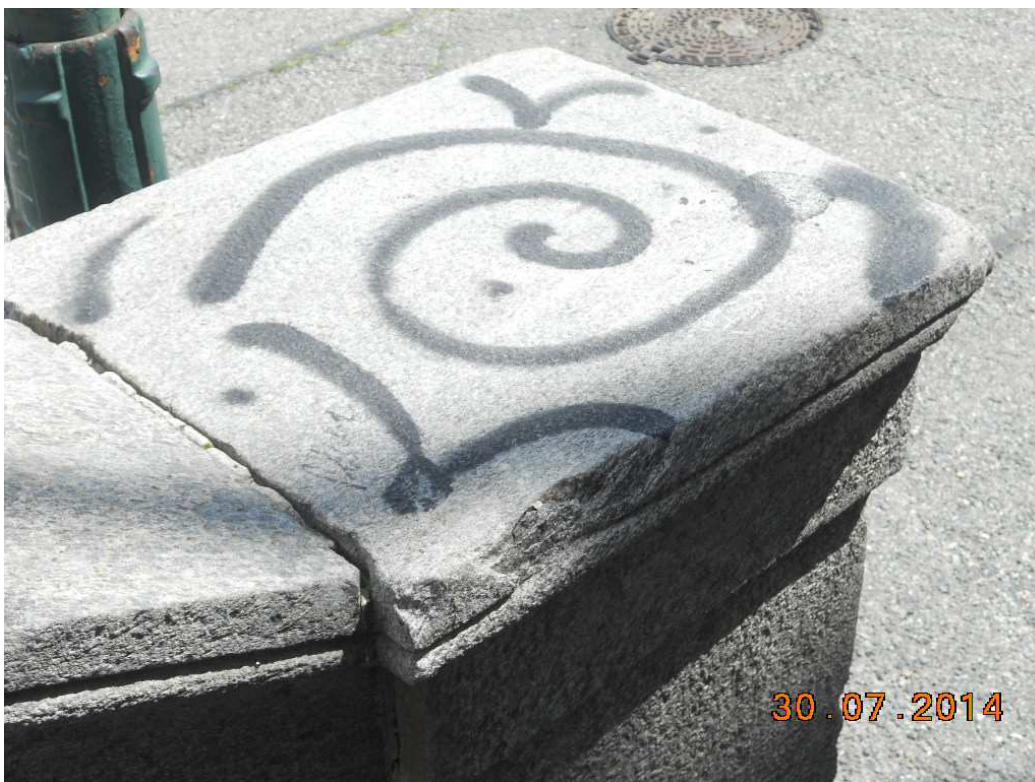
foto 23 parti mancanti del pilastro finale del modulo R della scala A
