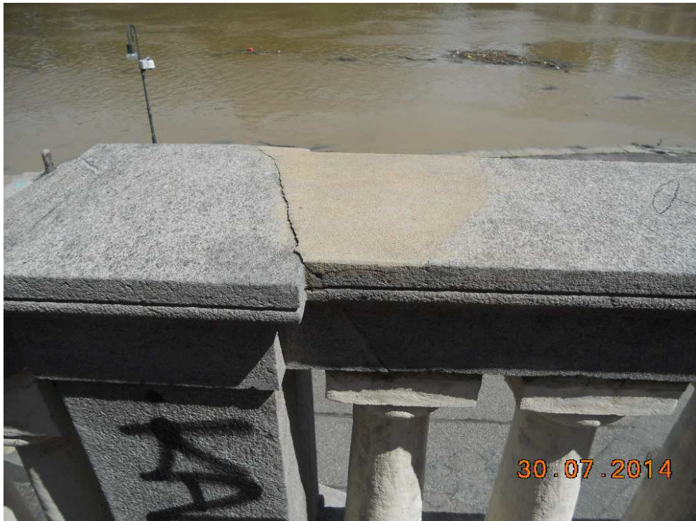
foto 19 lesione della cimasa del modulo M della scala A e ripristini in cls
