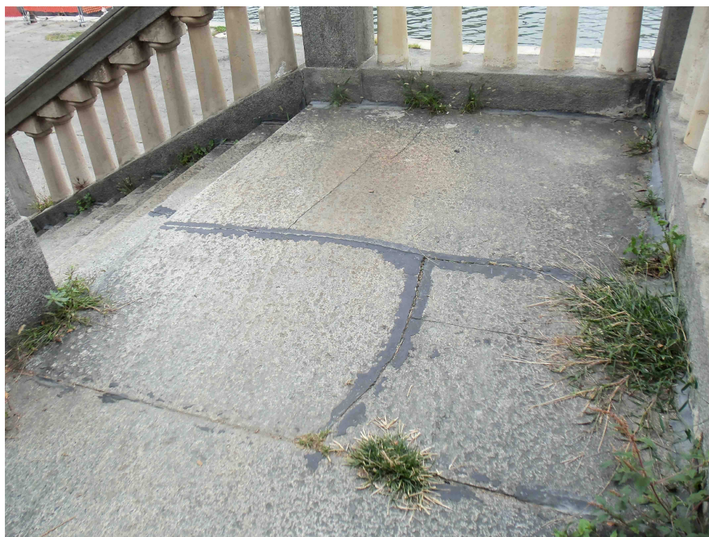
foto 16 lastra del pianerottolo in corrispondenza dei moduli E e F della scala A rotta
