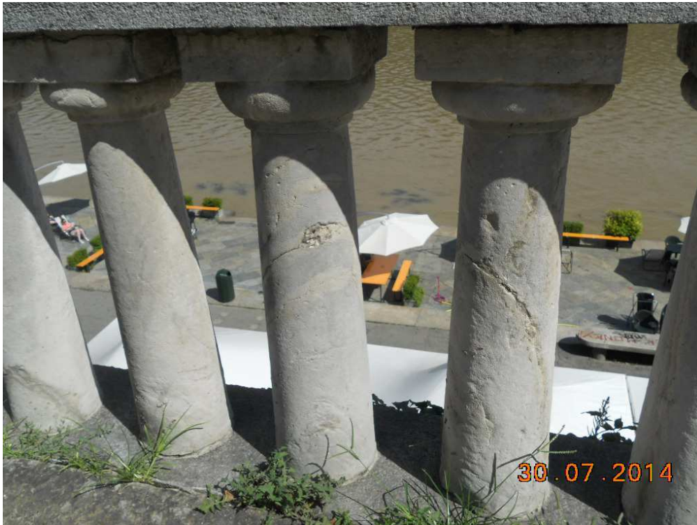
foto 35 colonnine lesionate nel modulo 31 (con ripristini in cls)
