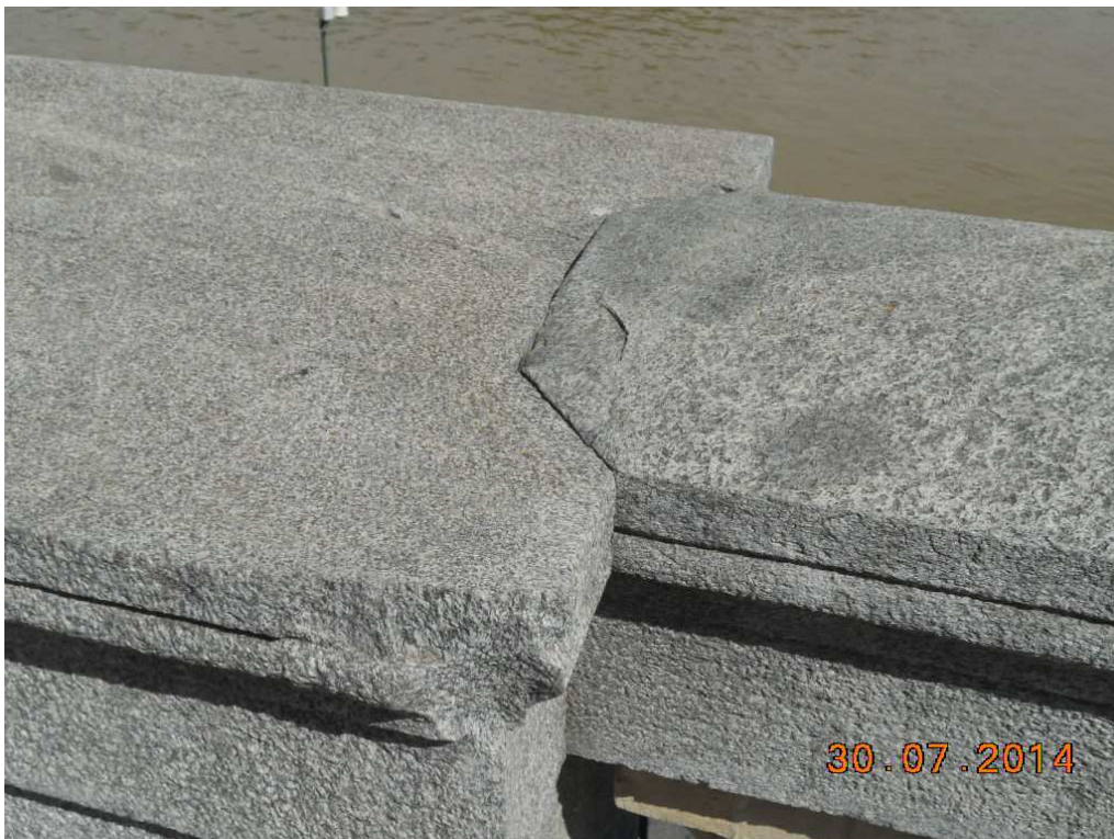
foto 26 angolo roto del pilastrino 20/21
