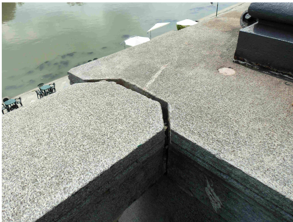
foto 39 pilastrino 33/34 e cimasa 34 sconnessi
