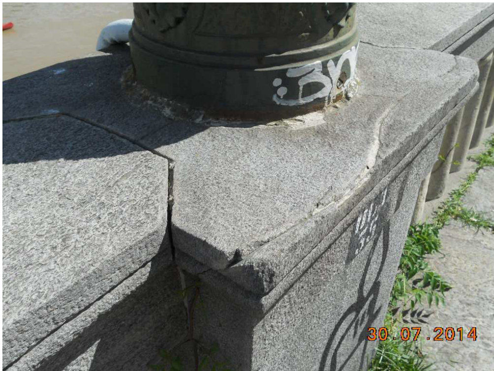
foto 32 piccole parti mancanti alla sommità del pilastro 27/28
