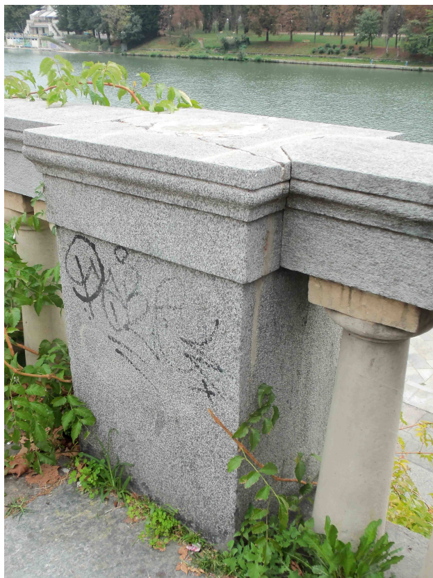
foto 33 lesioni del pilastro 28/29
