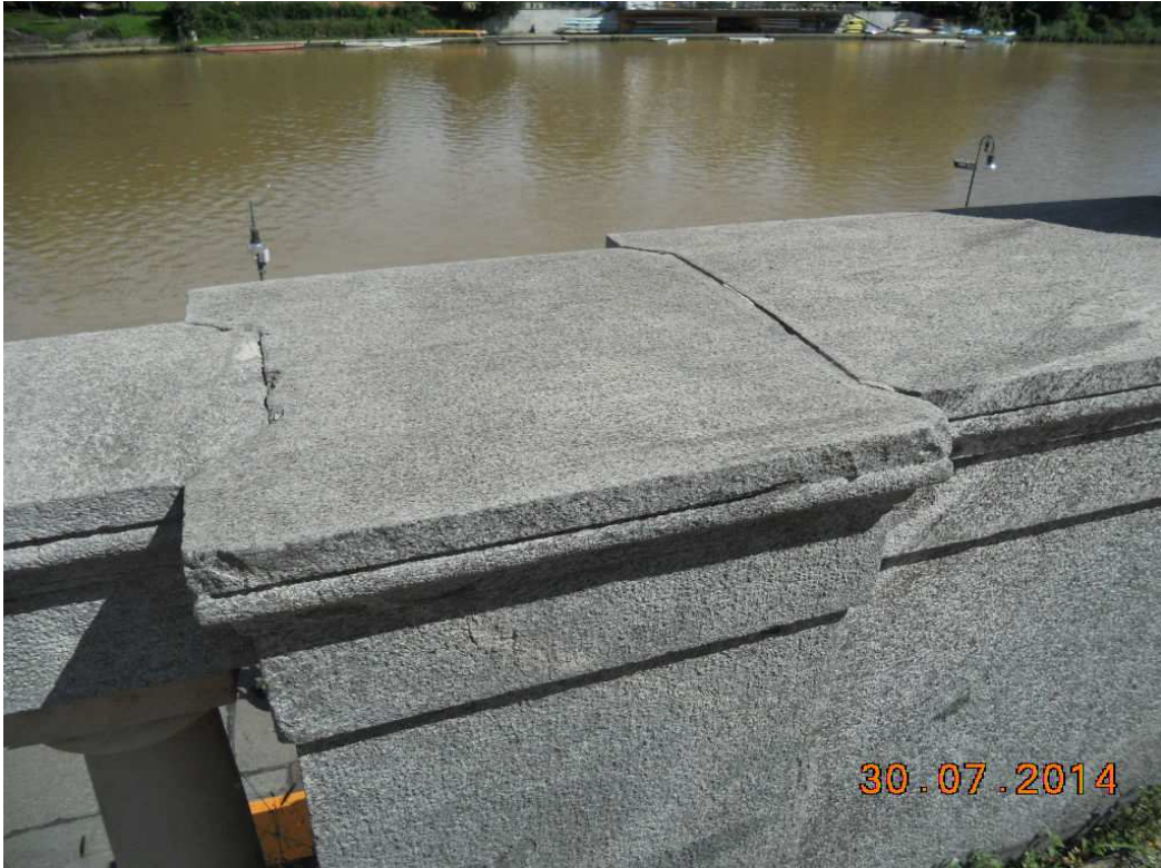
foto 27 angoli rotti del pilastrino 21/22
