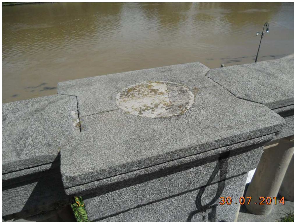
foto 30 lesione alla sommità del pilastrino 25/26
