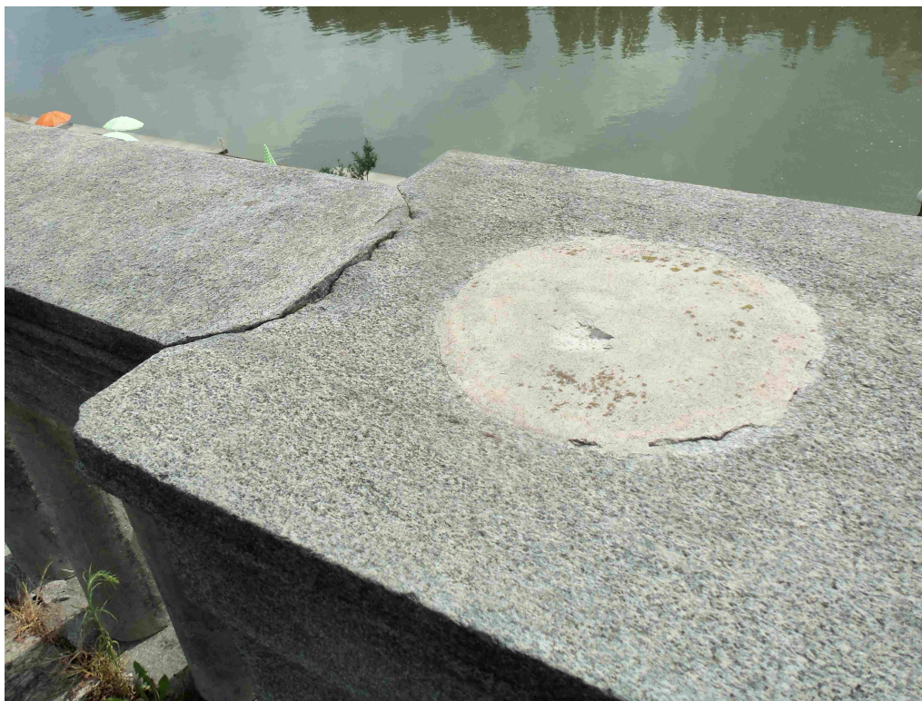
foto 43 piccola parte mancante della sommità del pilastro 37/38
