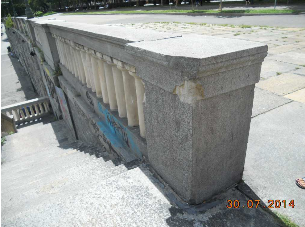
foto 13 angoli del pilastro finale 16 rotti e in parte ripristinati
