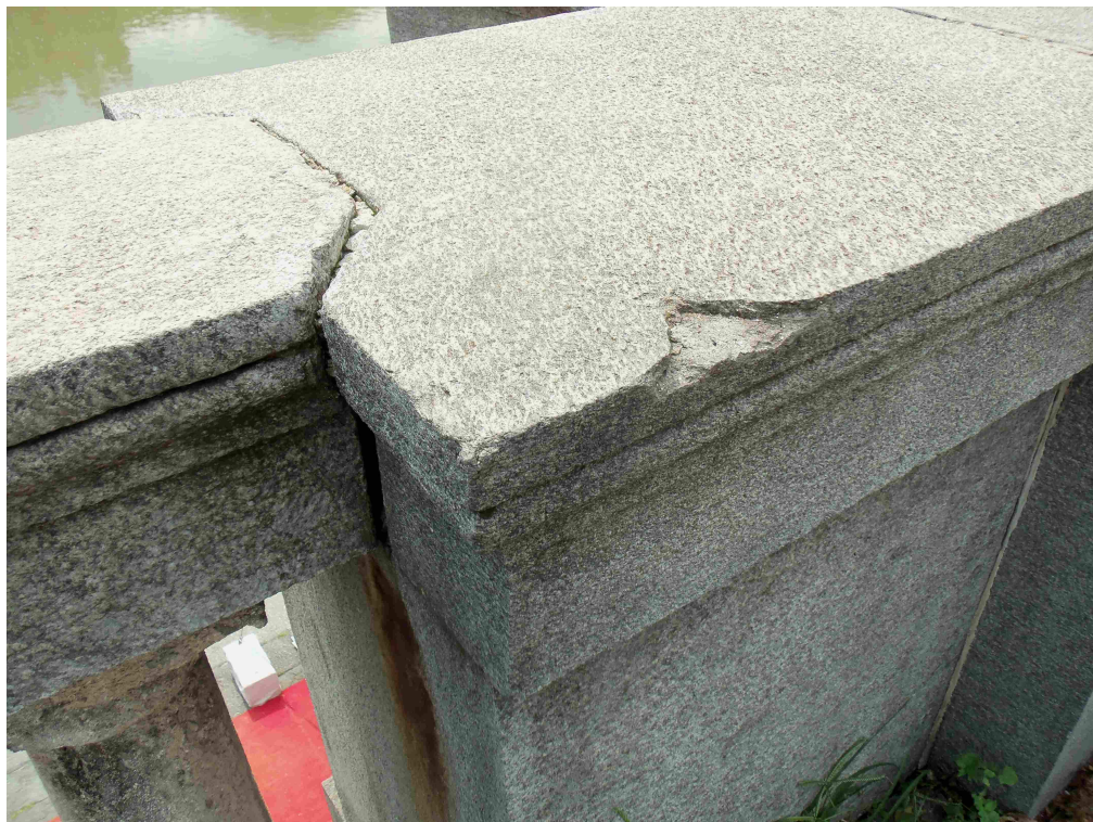
foto 47 pilastro 40/41 e cimasa 41 sconnessi, parte mancante alla sommità del pilastro 40/41
