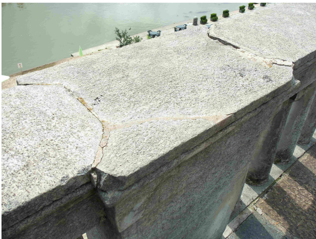
foto 52 angoli rotti e tassello in pietra del pilastro 42/43
