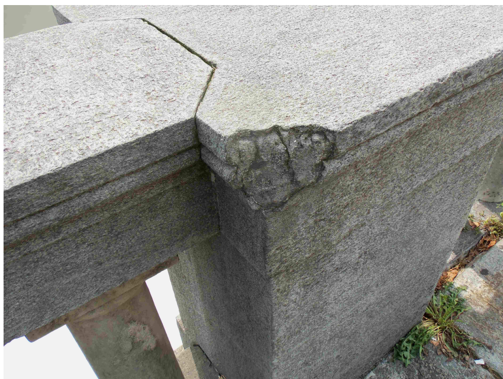
foto 40 angolo roto del pilastrino 35/36
