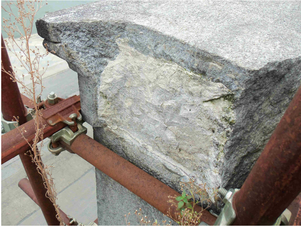
foto 61 parte rotta della sommità del pilastrino 48/49
