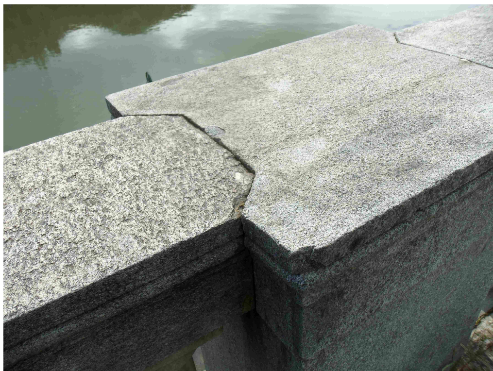
foto 44 piccola parte mancante della cimasa 39 e angoli rotti del pilastro 38/39
