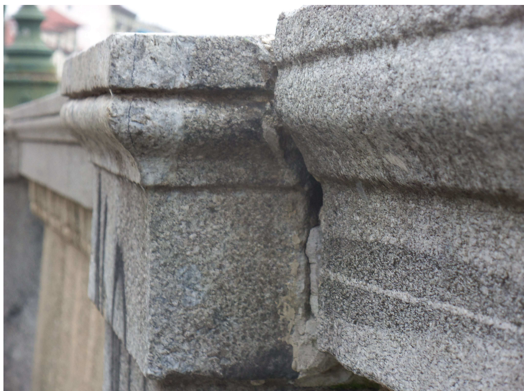
foto 04 giunto tra cimasa del modulo 4 e pilastro 4/5 non solidale
