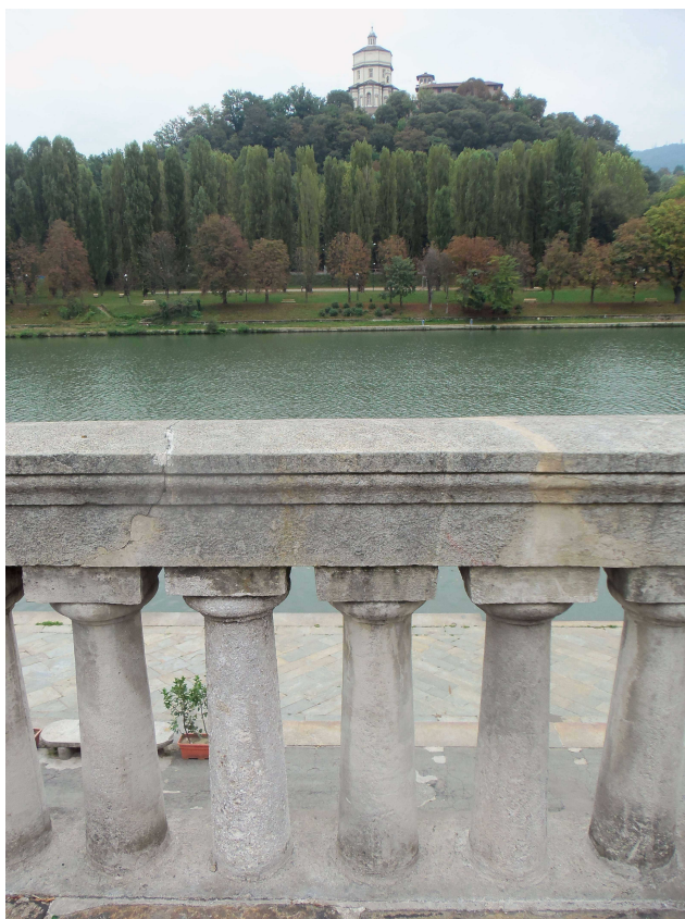
foto 53 lesioni della cimasa 43
