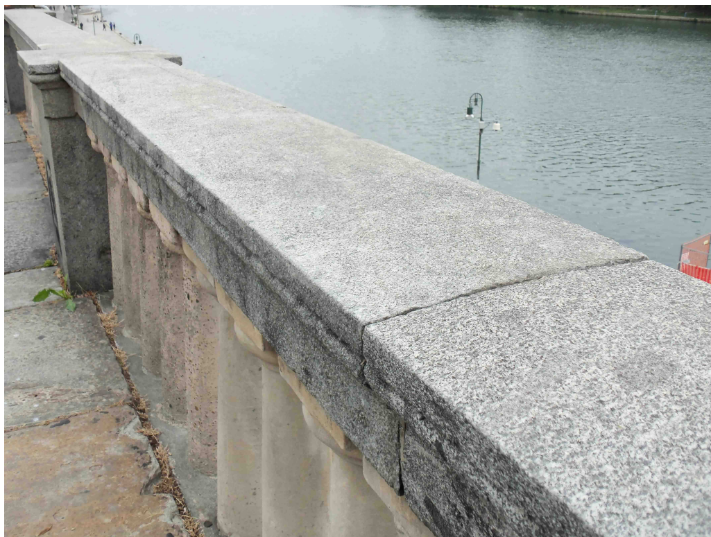
foto 24 lesione cimasa del modulo 18
