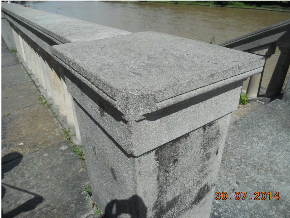
foto 25 angolo roto del pilastrino finale del modulo 20
