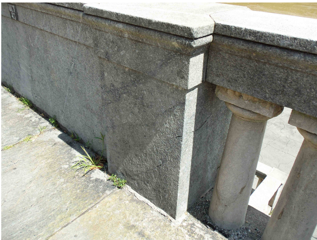
foto 12 lesione laterale del pilastro 14/15
