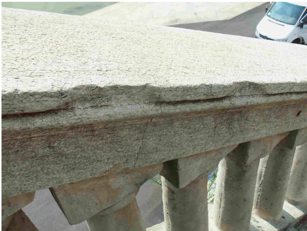
foto 73 lesione e parti mancanti della cimasa del modulo B della scala B
