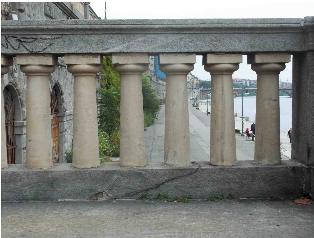
foto 21 zoccolo del modulo O della scala A fessurato
