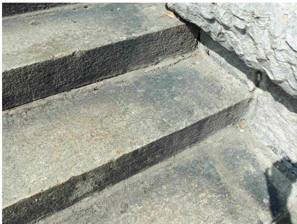
foto 80 4° gradino a scendere del modulo N della scala B lesionato
