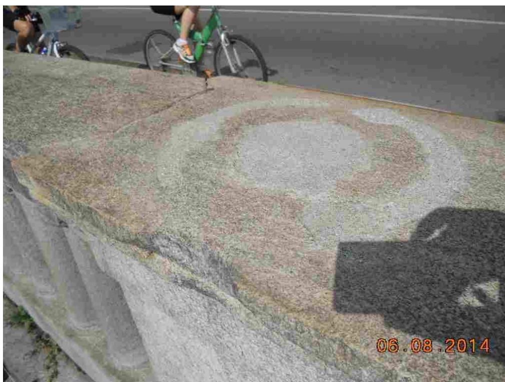
foto 86 parti mancanti della sommità del pilastro 72/73
