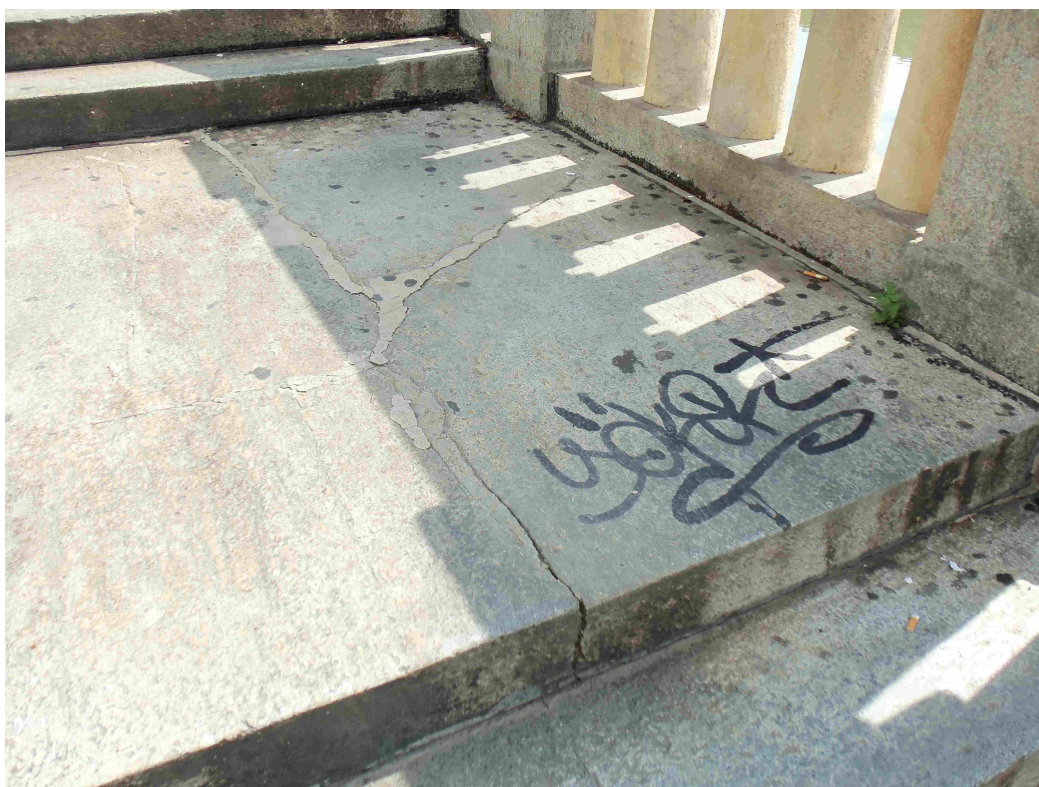
foto 74 pianerotto in corrispondenza del modulo C della scala B e 1° gradino ascendere rotti
