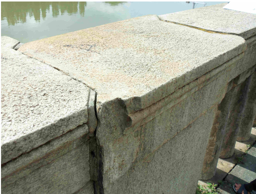
foto 67 parti del pilastro 61/62 sconnesse e angolo rotto
