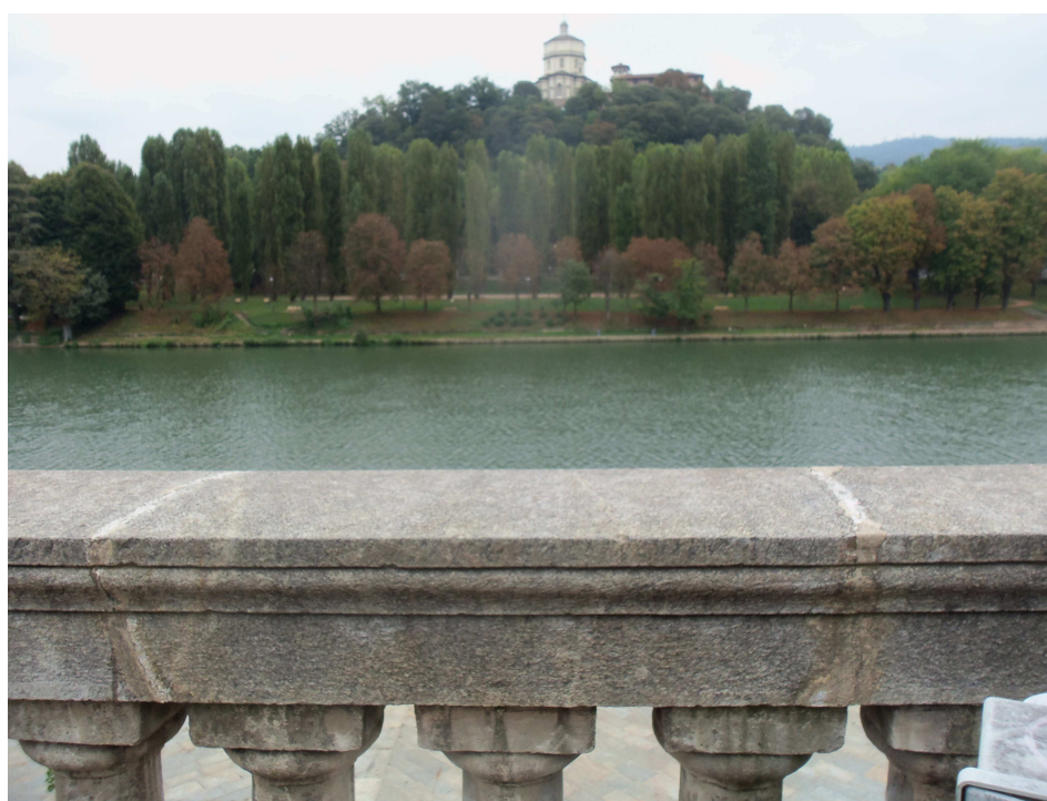
foto 50 lesioni della cimasa 42
