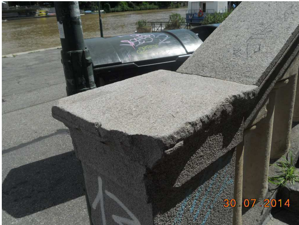
foto 18 parti della sommità del pilastro finale del modulo H della scala A mancanti
