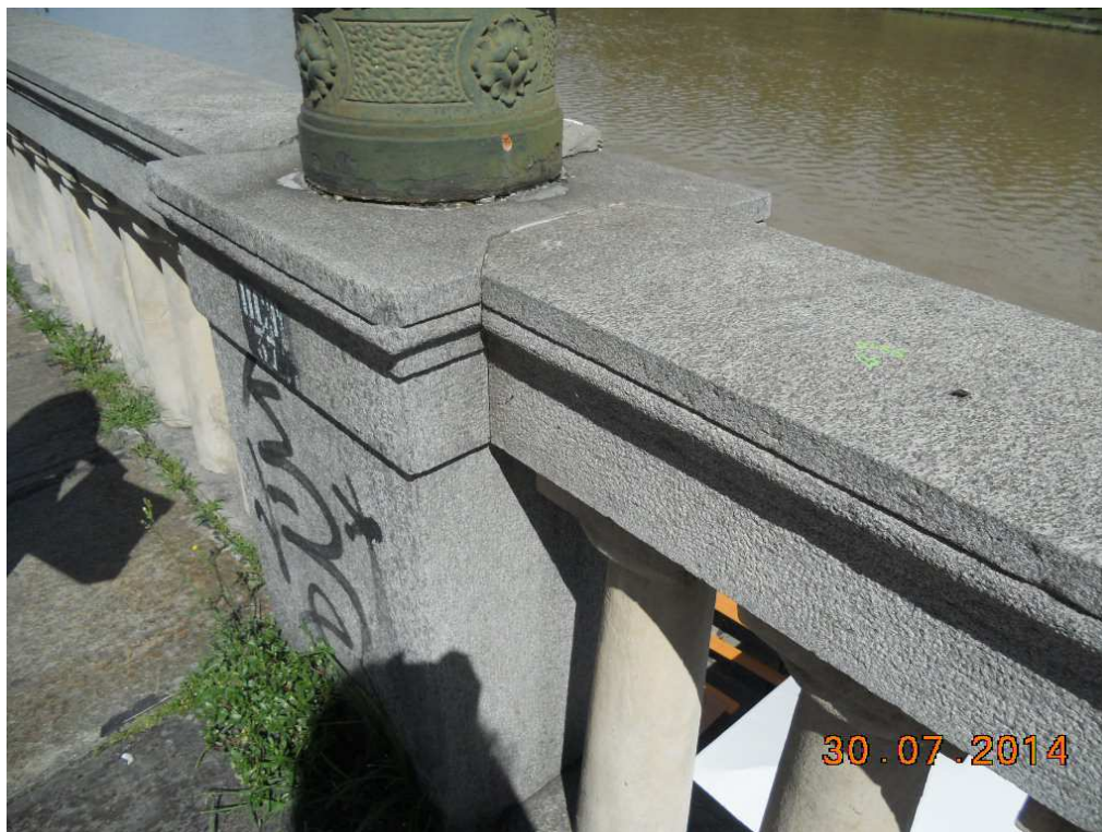
foto 29 angoli rotti del pilastrino 24/25
