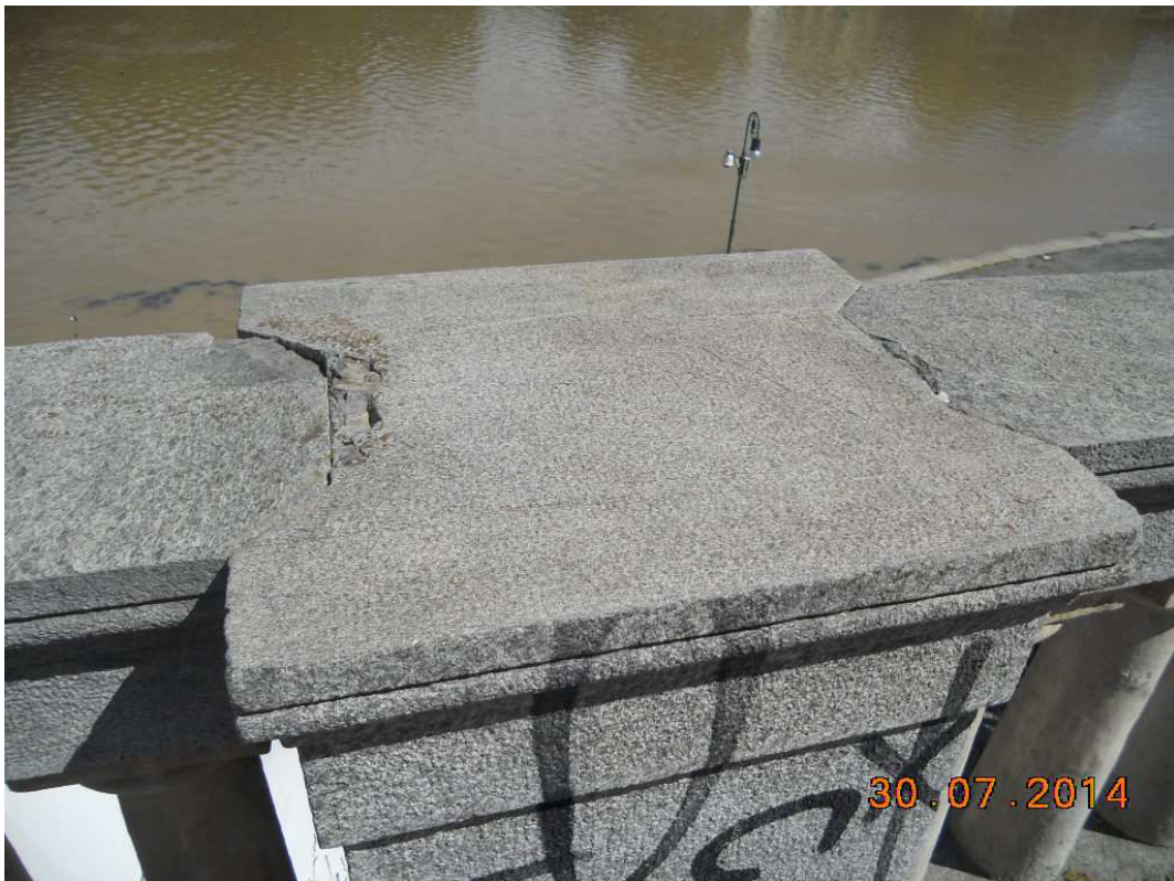
foto 28 piccole parti mancanti del capitello del pilastrino 23/24
