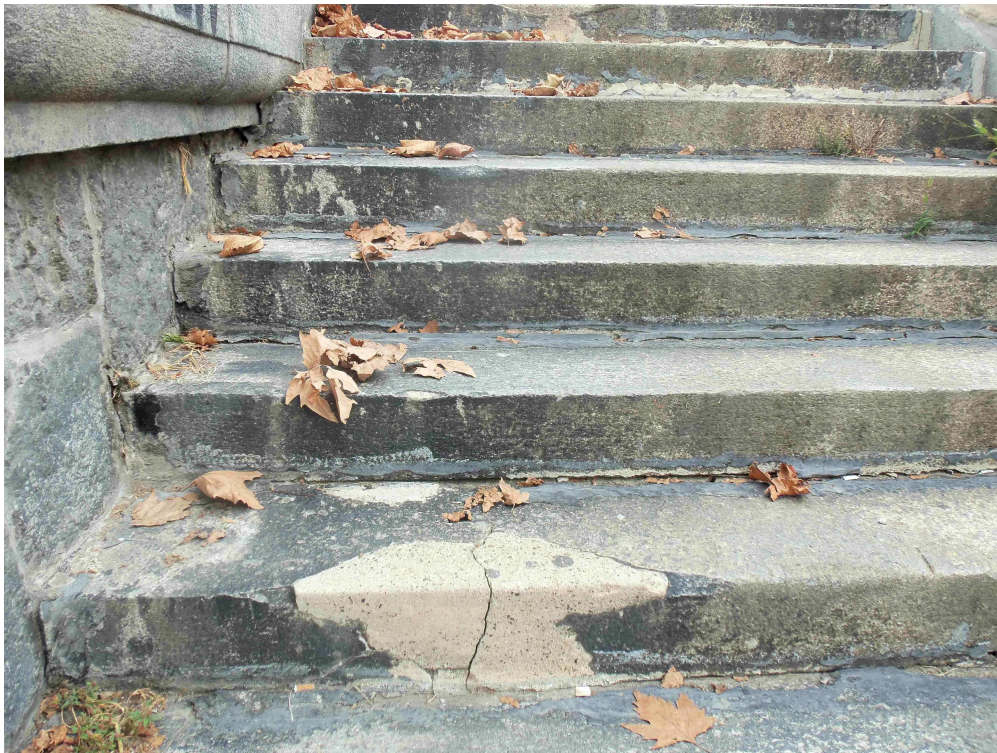
foto 14 8° e 9° gradino a scendere in corrispondenza dei moduli A e B della scala A rotti
