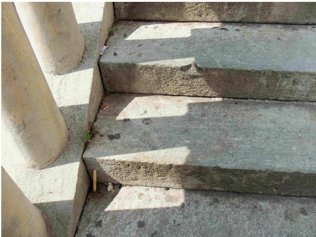
foto 77 4° gradino a salire della H della scala B lesionato
