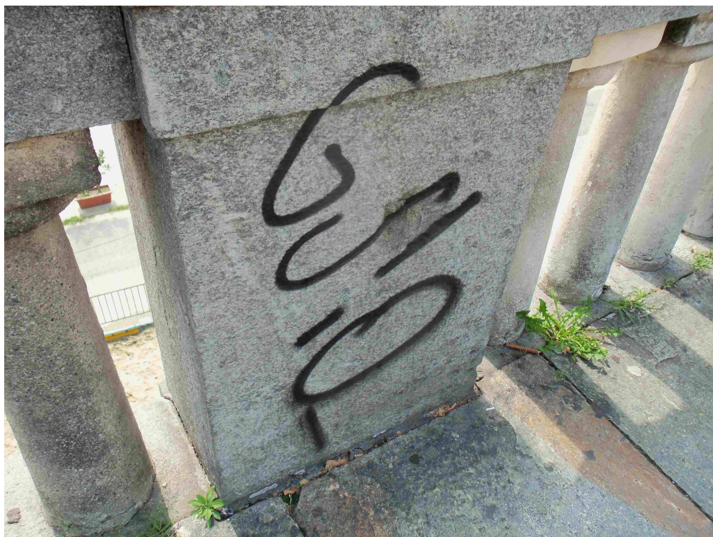
foto 63 parte mancante del pilastro 50/51
