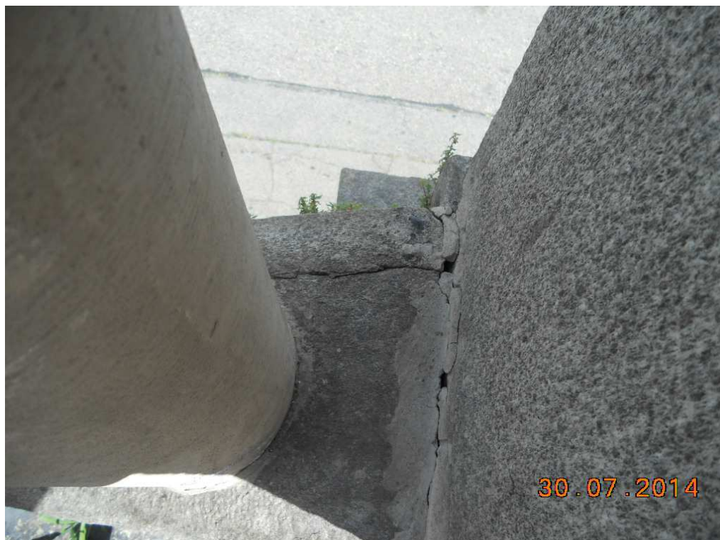
foto 17 zoccolo del modulo G della scala A fessurato
