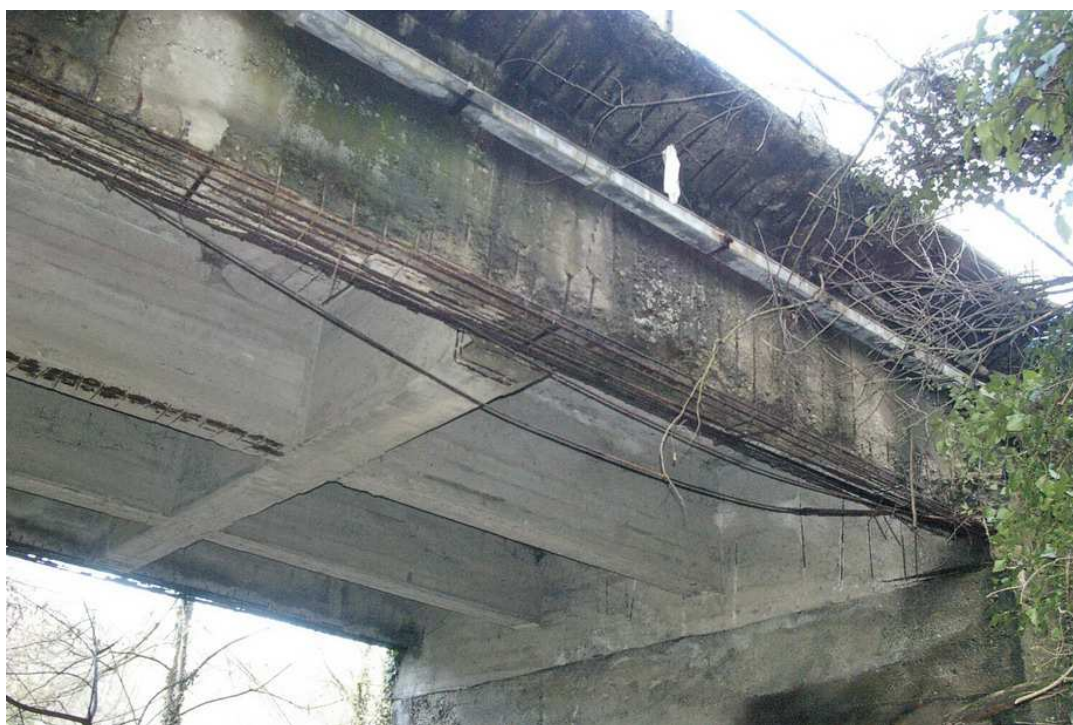
Foto 3 – Degrado delle strutture
