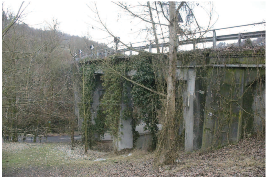
vista ponte da monte in destra, abbondante vegetazione sulle strutture
