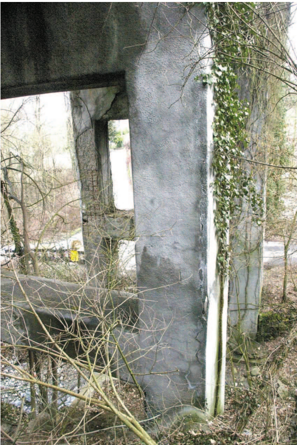
4 a pila pilastro a monte, lesioni sugli spigoli
