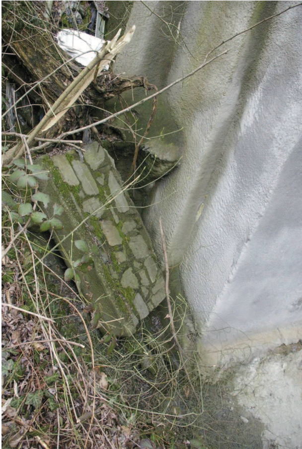
erosioni al piede muro andatore a monte in sinistra
