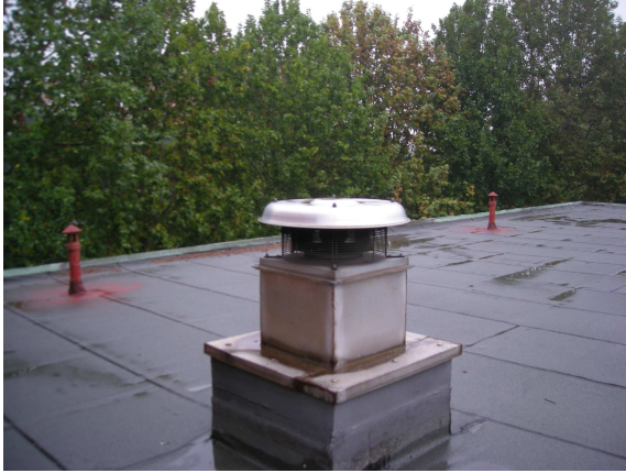
Tubi di aerazione in copertura
