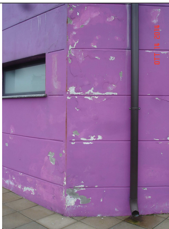
Dettaglio della facciata ammalorata al 2°P.
