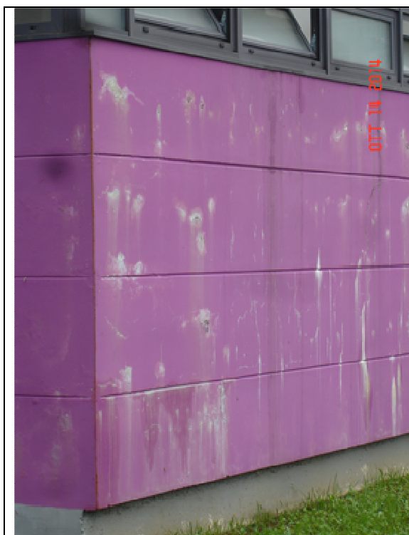
Dettaglio della facciata ammalorata al P.T.
