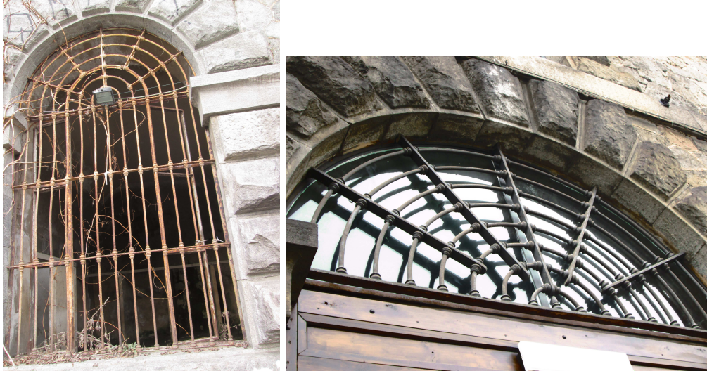
Foto 8 - Inferriate finestra e sopra luce.
