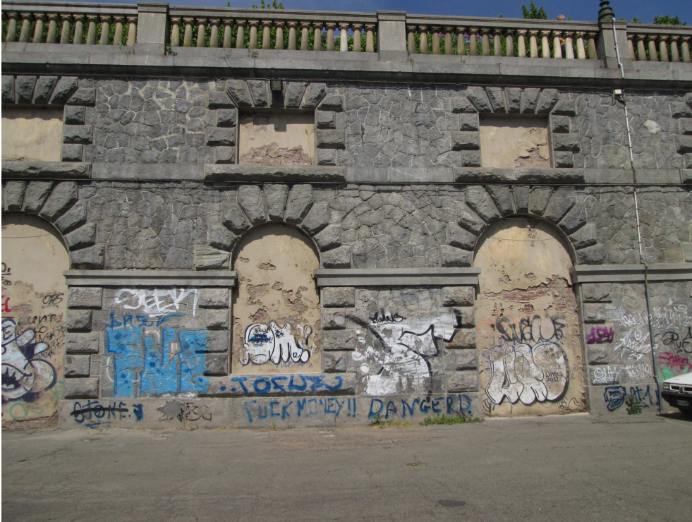
Foto 11 – Sfondati in intonaco tratto finale lato a valle.
