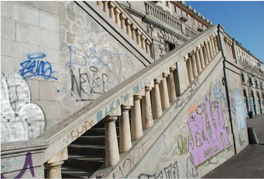
Atti vandalici presenti sulle scalinate
