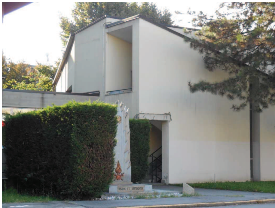
Foto 4 – Auditorium - Distacchi di intonaci su facciate esterne
