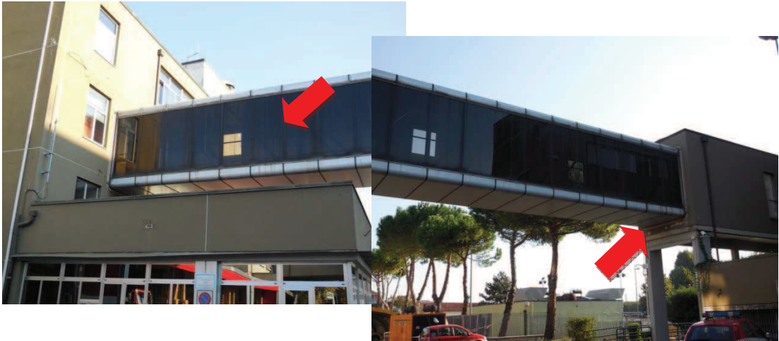
Foto 11 – Passerella collegamento Fabbricato A/B – Infiltrazioni
