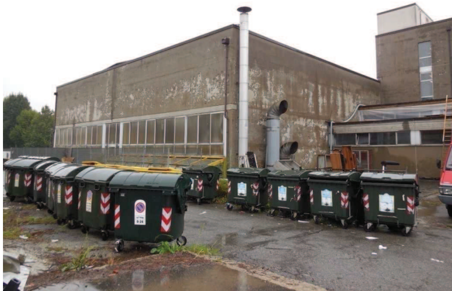
Foto 8 – Intonaci delle facciate ammalorati (zona piscina/palestra)
