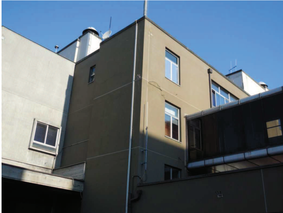
Foto 3 – Fabbricato A - Uffici – Distacchi di intonaci su facciate esterne
