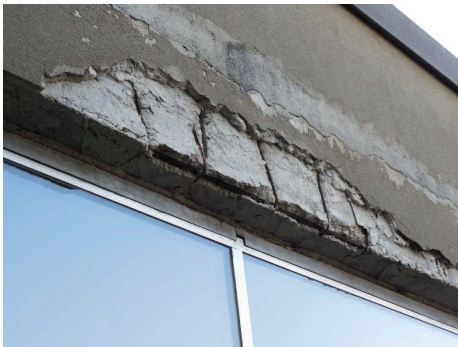
Foto 5 – Fabbricato B – Camerate Torretta Centrale – Distacchi di intonaci
