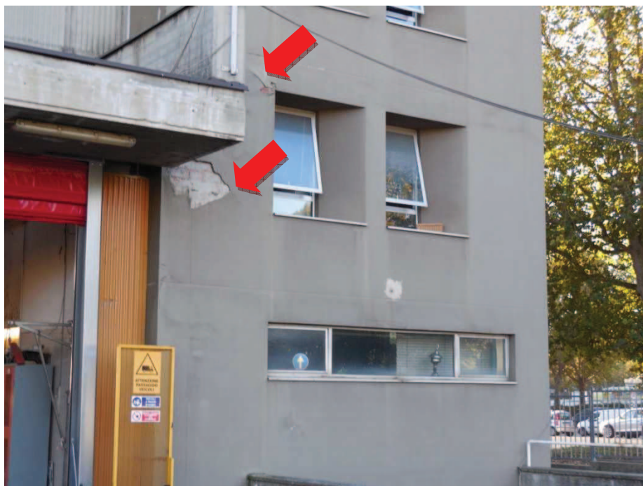
Foto 7 – Intonaci delle facciate ammalorati (zona SAF)
