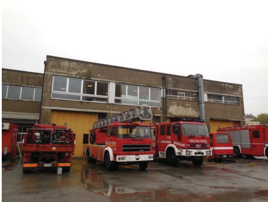
Foto 9 – Intonaci delle facciate ammalorati (zona mensa/cucina)
