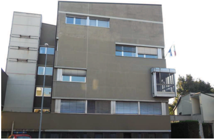
Foto 2 – Fabbricato A - Uffici – Distacchi di intonaci su facciate esterne
