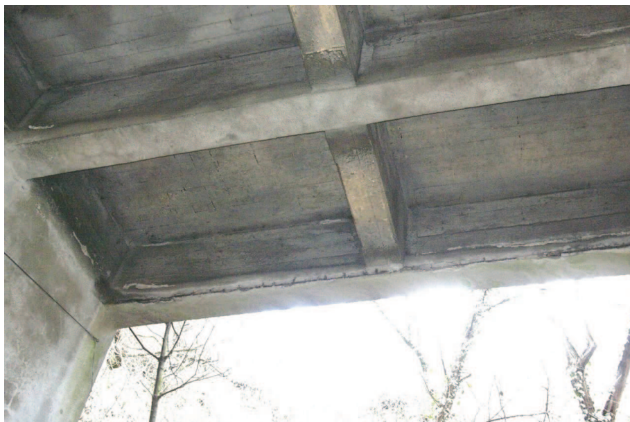
trave di monte 1 a pila, distacco copriferro all'intradosso
