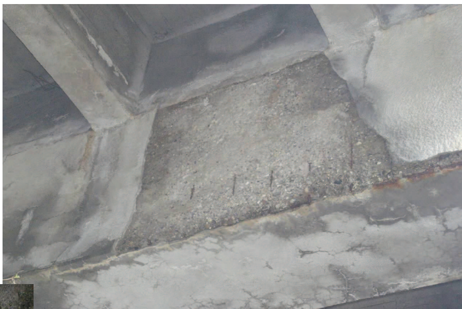
1ª pila, distacco intonaco da fianco destro del pulvino
