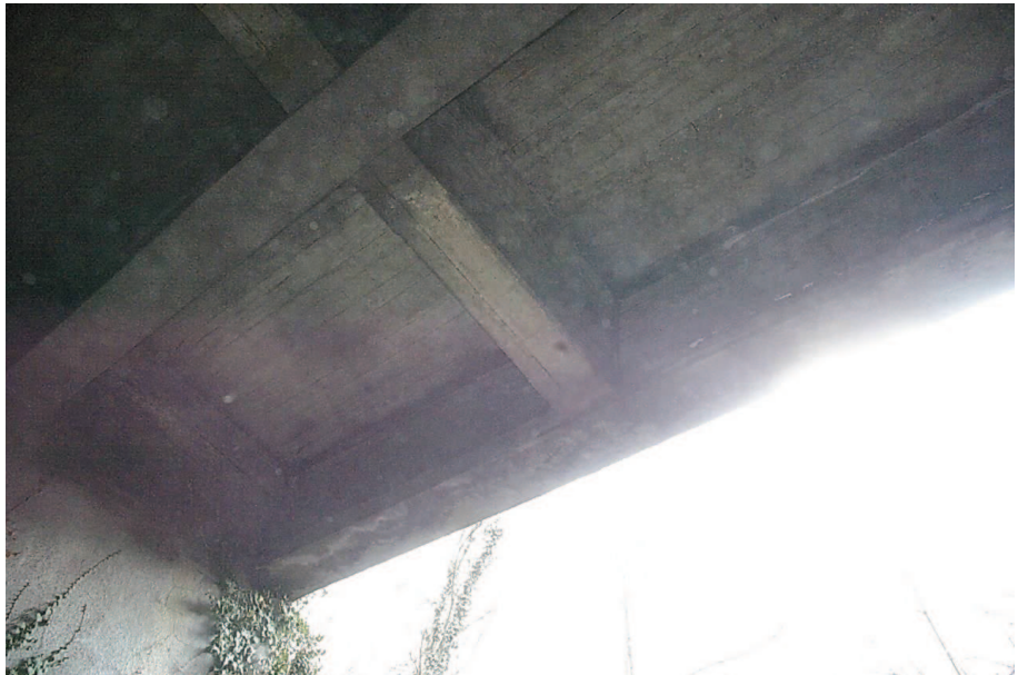
trave valle fessurata all'intradosso in 9 a campata
