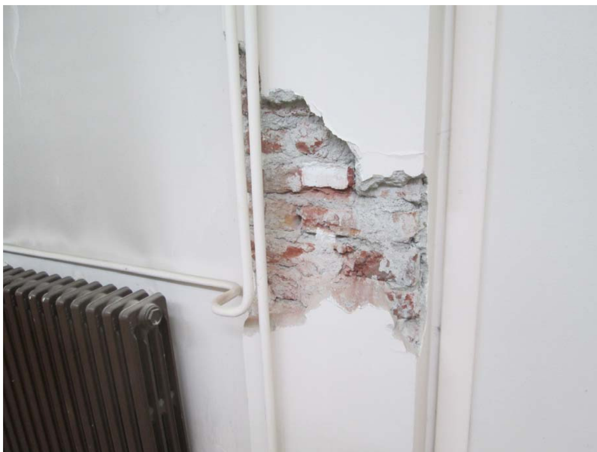
Foto n.16: Particolare del saggio n.8 sulla trave
