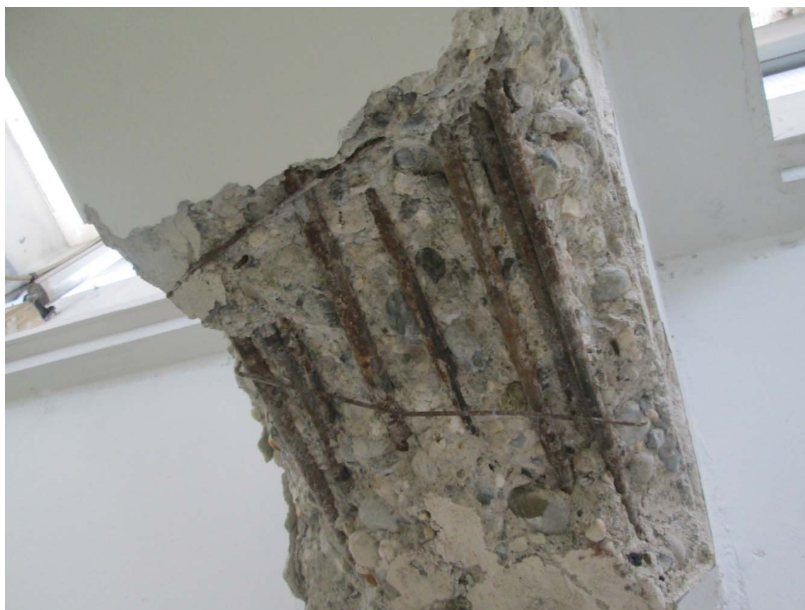
Foto n.4: Particolare del saggio n.2 sulla trave
