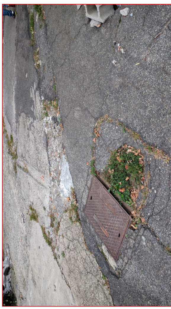
Stato di fatto del manto stradale
