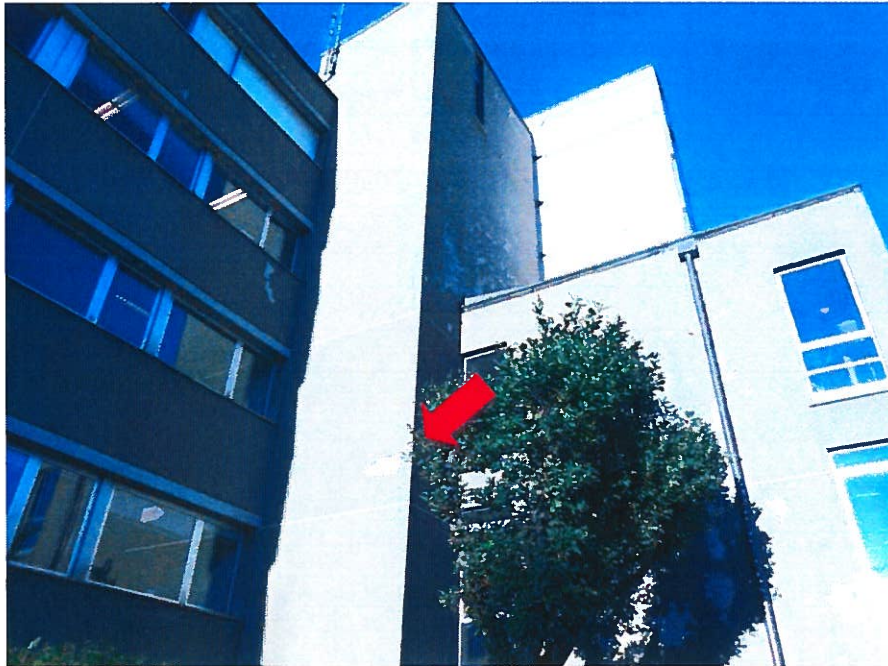
Foto 6 – Intonaci delle facciate ammalorati (zona uffici)
