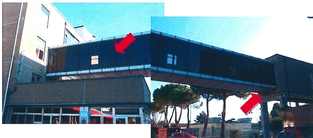
Foto 11 – Passerella collegamento Fabbriato A/B – Infiltrazioni
