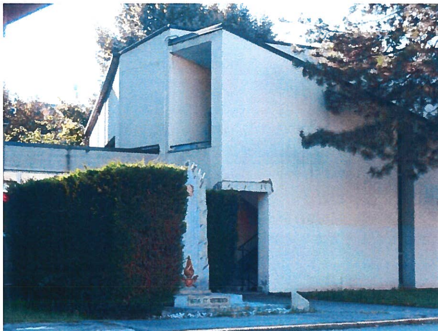
Foto 4 – Auditorium - Distacchi di intonaci su facciate esterne
