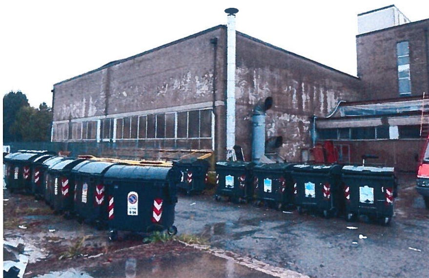
Foto 8 – Intonaci delle facciate ammalorati (zona piscina/palestra)
