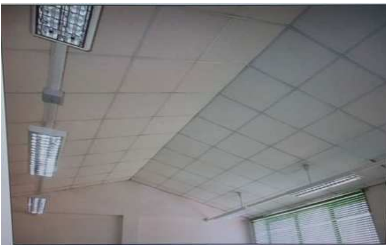
Foto controsoffitto piano secondo via Corelli 4
